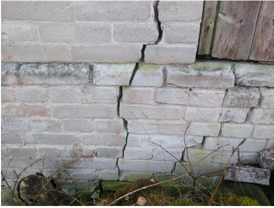
Bild 11 1232a.3 En större spricka vid dörröppningen på fasaden mot nordöst.
