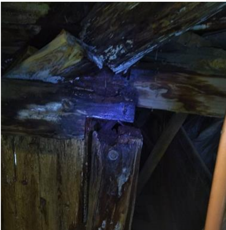
Bild 17 1232b.3 En närbild av skadan i bild 15
