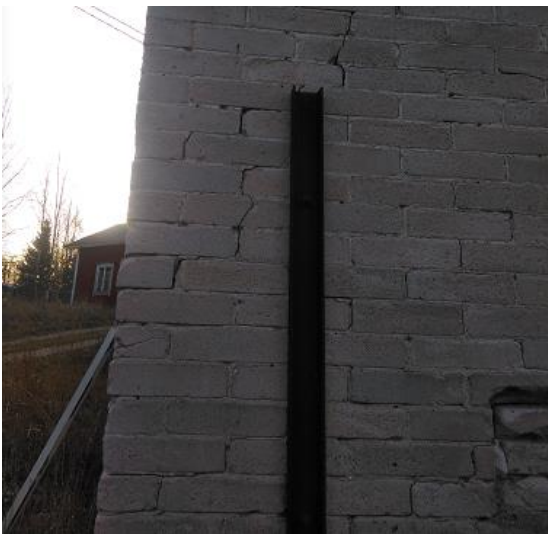
Bild 12 1232a.4 Den andra sidan av östra hörnet som på bilderna 8 och 9 , även här syns sprickbildning och i mitten av bilden järnbalken som stöder upp muren, en likadan järnbalk finns på motsatt mur med en järnstång fastspänd i båda. Till vänster lutar ett vattenpass mot husväggen.
