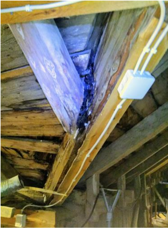
Bild 29 1261.4 Södra giren. Takstolarna har delvis släppt från varandra, de är också båda rötskadade.
