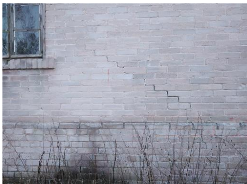
Bild 6 1212.2 Ett annat ställe på en spricka som börjat på liknande sätt som i bild 4.
