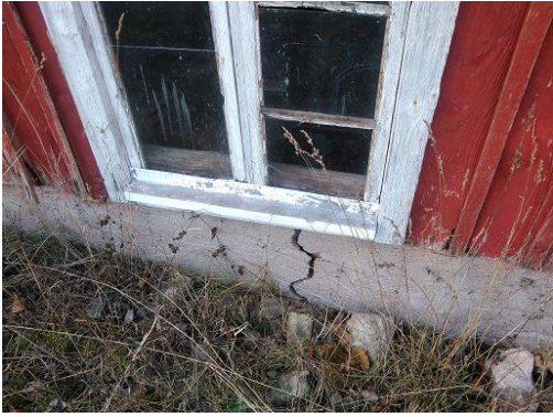
Bild 7 1212.3 En större spricka i den gjutna sockeln.
