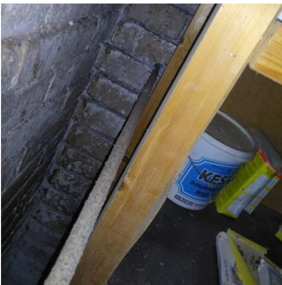
Bild 13 1232a.5 På bilden syns järnstången som stöder upp det östra hörnet.
