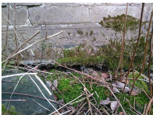
Bild 5 1212.1 Det har bildats hål mellan marken och grundplattan på några ställen vilket lett till sprickbildning.
