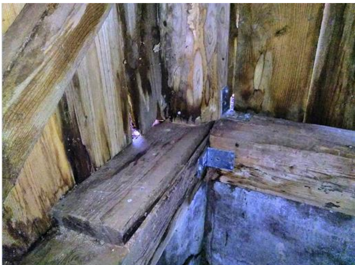
Bild 15 1232b.1 På bilden en syllstock i det sydvästra hörnet, under rampen till hövinden. Det har sluppit att rinna in större mängder vatten här p.g.a. att marken lutar mot husgrunden och stocken börjat ruttna. På bilden kan man se att den blivit utbytt mot en impregnerad stock.
