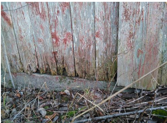
Bild 19 1241.1 Röta i brädfodringen, bilden tagen till höger om fönstret man ser på bild 19 .
