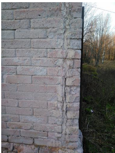
Bild 9 1232a.1 Bild från det östra hörnet, man kan se en större spricka och man kan också se att det någon gång har gjorts ett försök att lappa sprickan.
