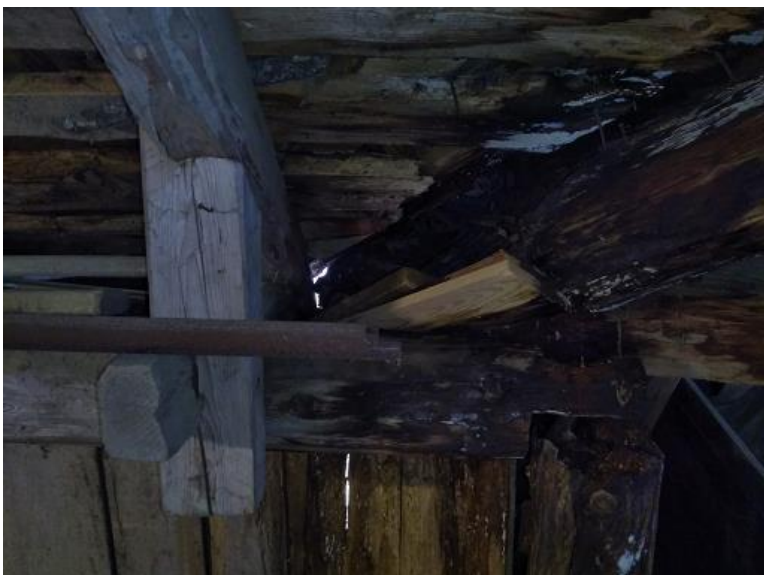
Bild 16 1232b.2 På bilden den nordvästra giren. Vatten har sluppit in här under längre tid och giren är rutten. Hammarbandet har släppt från övriga stommen och den ovanpåliggande takstolen. Takstolen har stötts upp med kilar.
