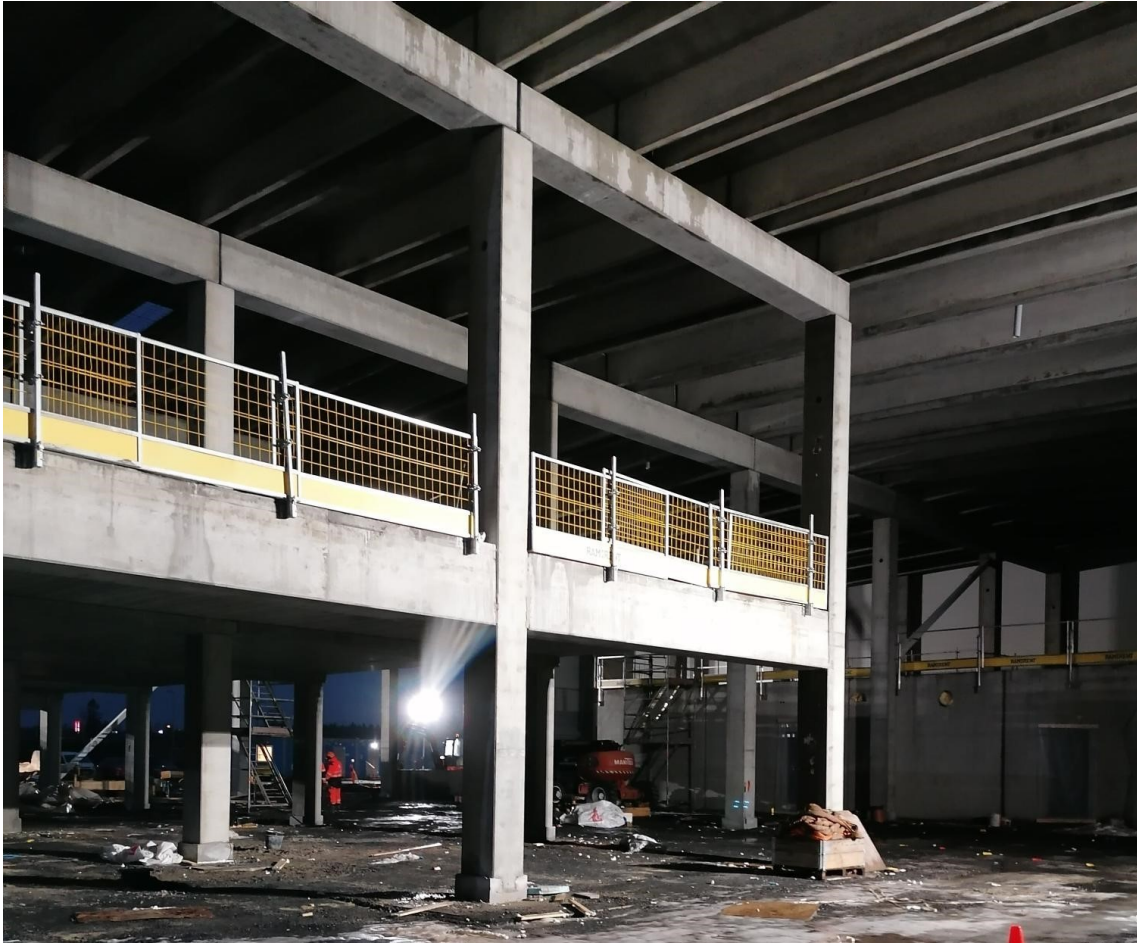
KUVA 6. Ontelokentän reunat suojattu suojakaiteilla
