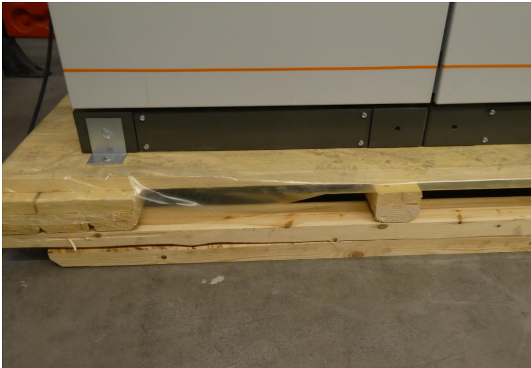
Kuva 15. Tehtaan lattialla oleva kojeisto kuljetuslavan päällä kojeisto.
