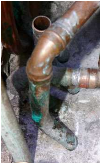
Kuva 6. Suojaamattoman kupariputken ulkopinnan korroosio betonissa (Plumbersdiary).
