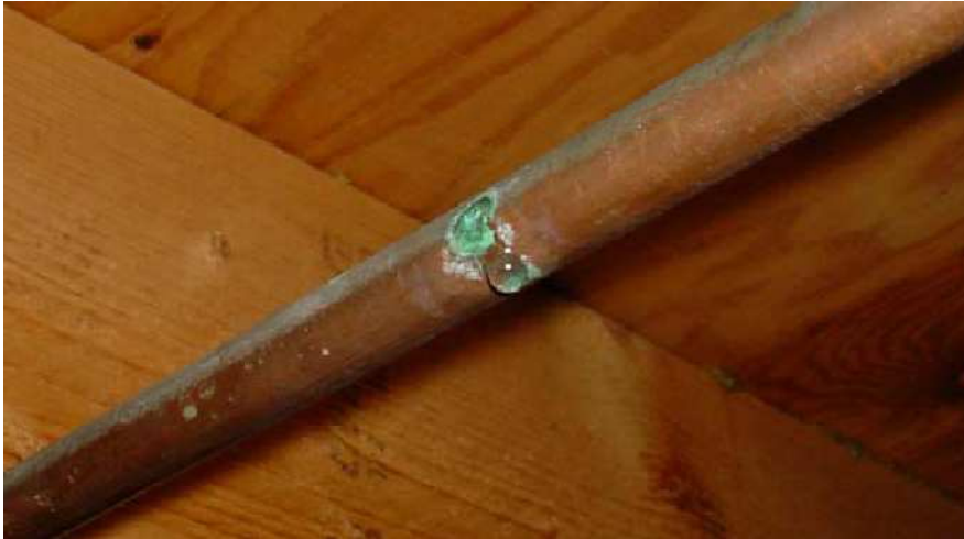
Kuva 3. Pistekorrosion aiheuttama vuoto kuparisessa käyttövesiputkessa (Ehrlich ym. 2004: 3).
