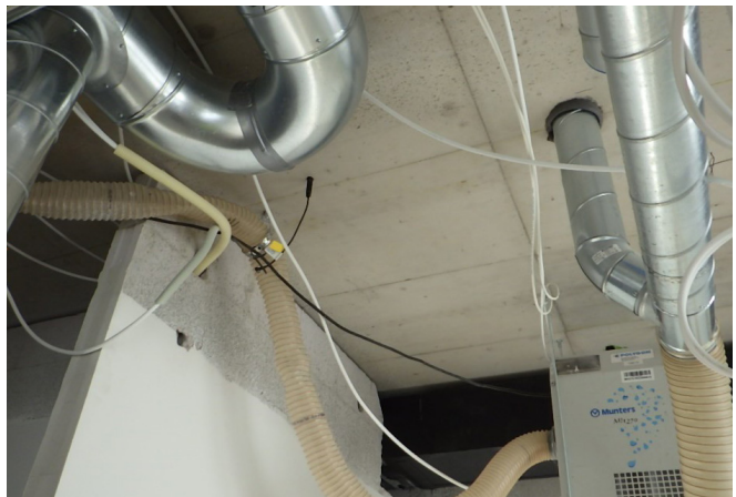
Kuva 8. Polygon Oy:n kuivatusjärjestelmää asennettuna (kuva: Polygon Oy)
