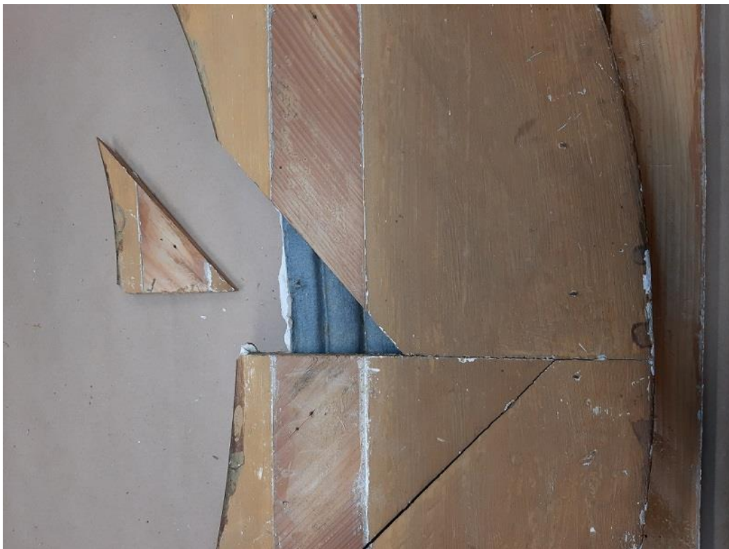
Kuva 11. Kehyksen taustapuolelta, vauriokohdasta, näkyy sini-harmaa paperinen kerros.
