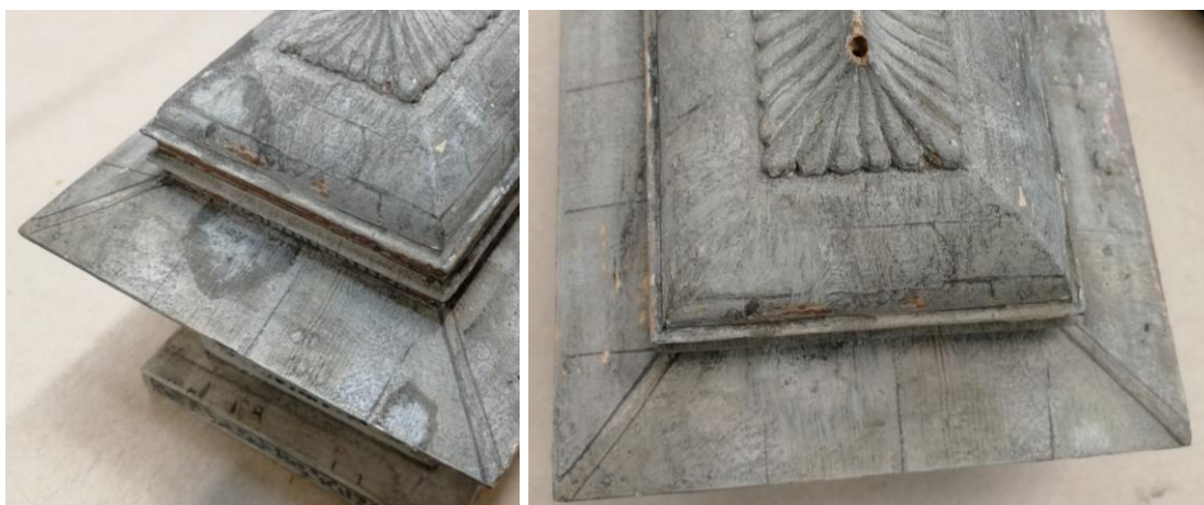
Kuva 31. Vasemmalla paviljonkiosassa esiintyviä kosteusvaurioita ja oikealla kosteusvauriot retusoinnin jälkeen.
