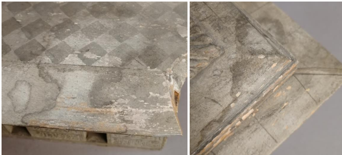
Kuva 22. Kohteessa esiintyviä kosteusvaurioita.
