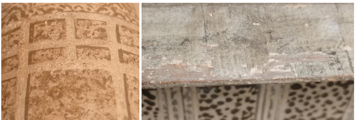
Kuva 21. Oikealla krakeloitunutta maalipintaa yhden minareetin rungossa ja vasemmalla irtoilevaa maalipintaa kattopaviljongin räystäään reunassa.
