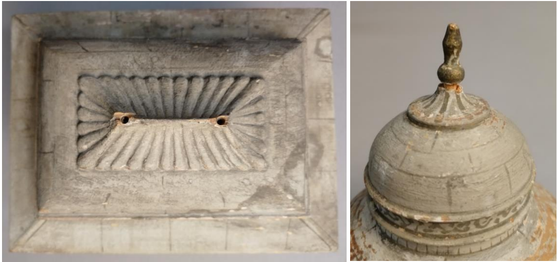
Kuva 18. Vasemmalla paviljongin päältä puuttuvien kattokoristeiden jättämät aukot ja oikealla minareetin katkennut koriste, joka ei ole kunnolla paikallaan.
