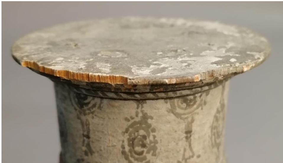
Kuva 19. Minareetin räystäässä olevia murtumia.
