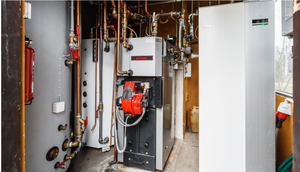
Kuva 2. Taloyhtiön tekniseen tilaan asennettu NIBE:n maalämpöpumppu ja varaaja.
