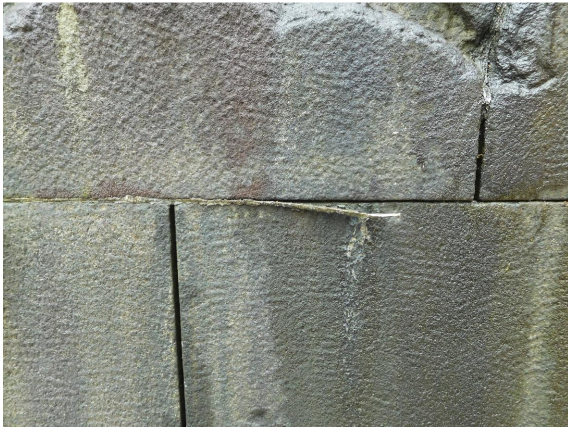
Kuva 16. Pohjanneidon alla olevien jalustakivien välissä olevat lyijysaumaukset ovat kadonneet ja osittain irti.
