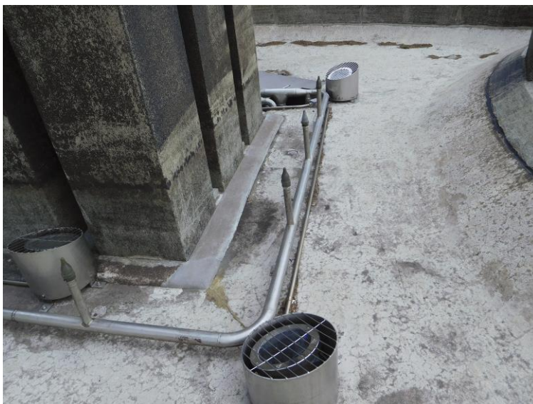
Kuva 4. Pohjanneito -veistoksen alla olevien graniittipaalujen ympärillä olevia vesiputkia ja valaisimia vesialtaan pohjassa.
