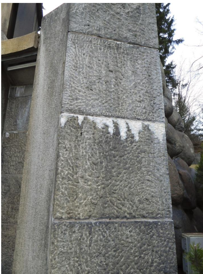
Kuva 15. Saumauksista tulevia valkoisia valumajälkiä.
