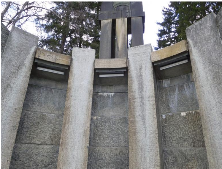
Kuva 3. Valaisimet graniittipaalujen välissä.
