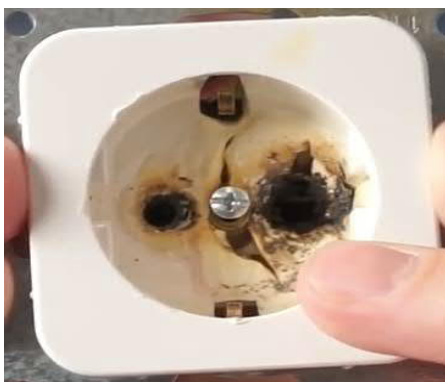
KUVA 1. Jatkuvassa kuormituksessa oleva pistorasia voi ylikuumentua ja aiheuttaa palovaaran (Tukes)
