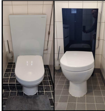
Kuva 17. Geberit-wc-istuimia kerroksessa 2 (Blomqvist 18.3.2019)
