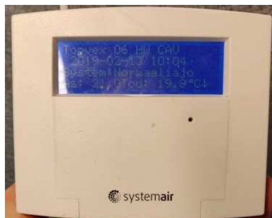
Kuva 9. Ilmanvaihtokoneen säätöyksikkö (Blomqvist 18.3.2019)
