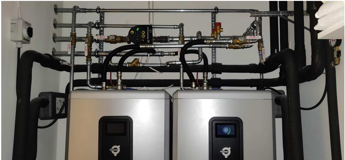
Kuva 10. Maalämpöpumput ja maalämpökaivojen putkituksia (Blomqvist 18.3.2019)
