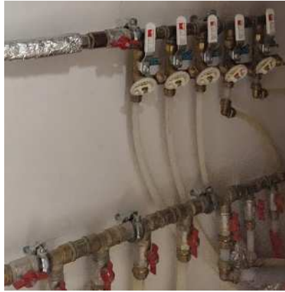
Kuva 15. Kiertojohdot ja säätöventtiilejä (Blomqvist 18.3.2019)
