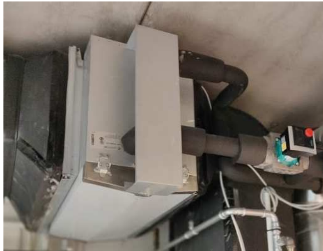
Kuva 8. Ilmanvaihtokoneen jäähdytyspatteri (Blomqvist 18.3.2019)
