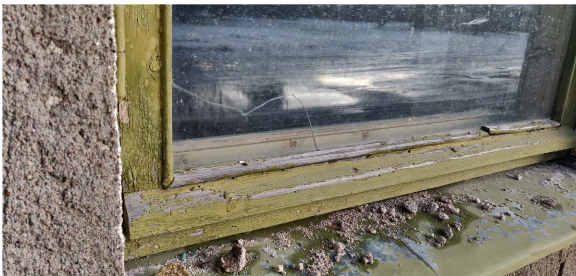
Figur 5 Ett av granskningsobjektets spruckna fönster.
