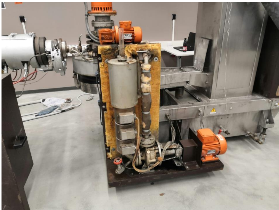
Kuva 14. Granulaattorin lämmitysspannat ja lämpöeristykset
