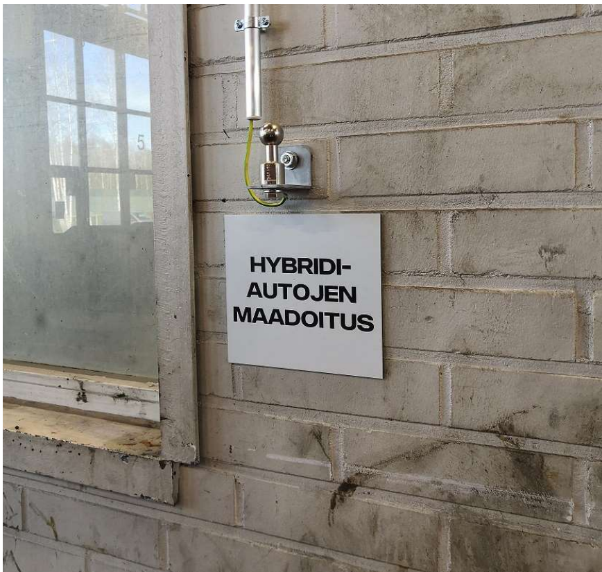
Kuva 2. Korkeajänniteajoneuvon maadoituspaikka korjaamohallissa.
