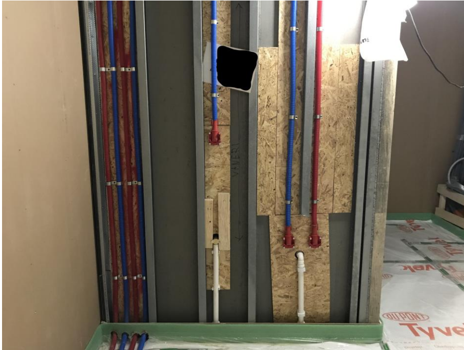
Kuva 4. Yleiskuva seinässä olevista vesi, lämmitys ja viemärointi putkista.
