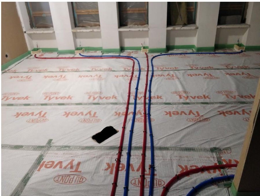
Kuva 2. Yleiskuva asunnon lattialla kulkevista lämmitysputkista
