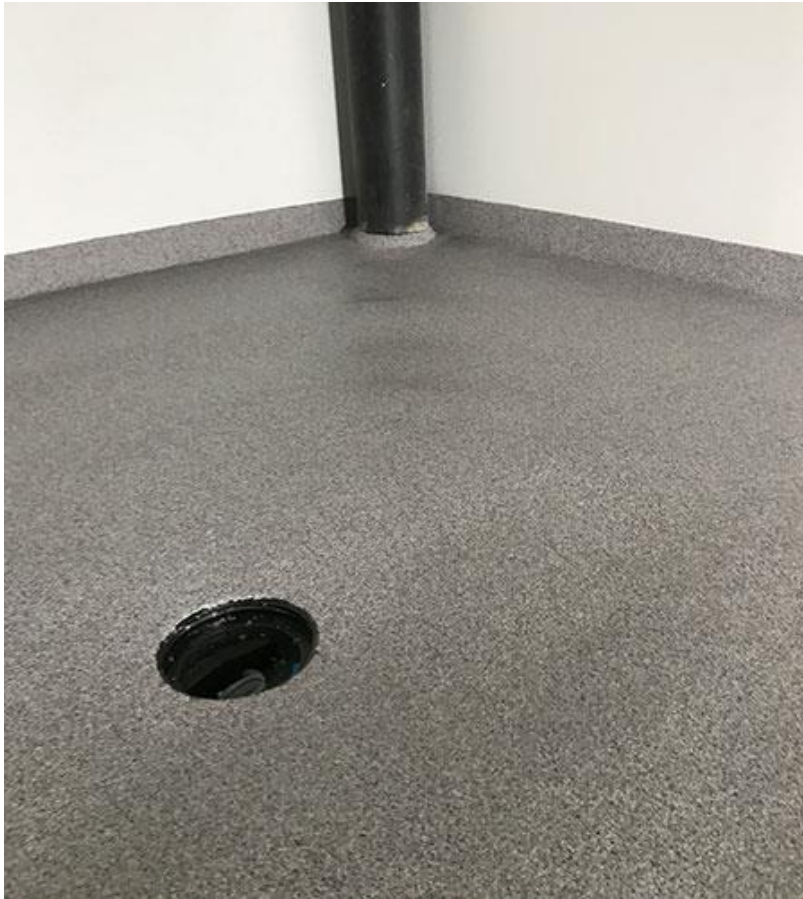
Kuvio 3. Akrylibetonilattia (Etelä-Suomen Lattiapinnoitus)
