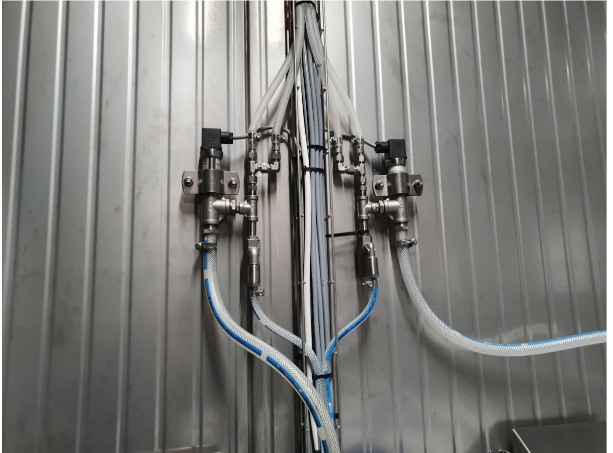
Kuva 15. Keskusannostelun paineanturit ja varoventtiilit
