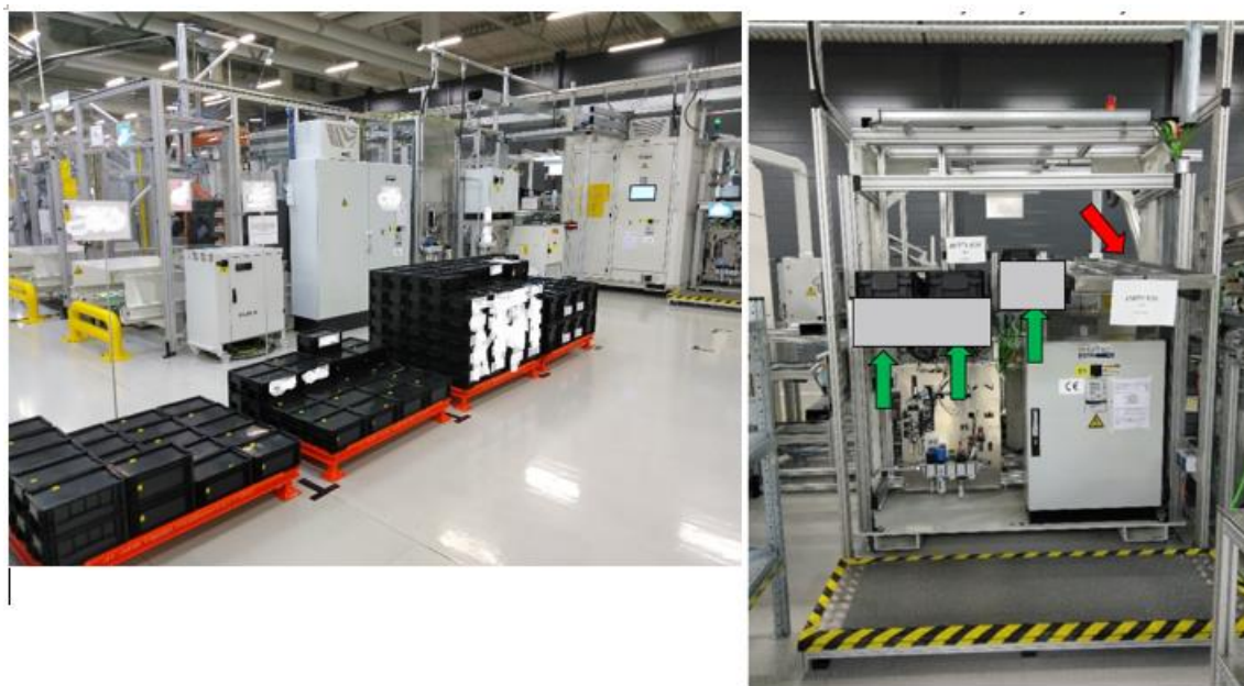
Kuva 12. Buffer-paikka sekä materiaalin syöttö linjalle.
