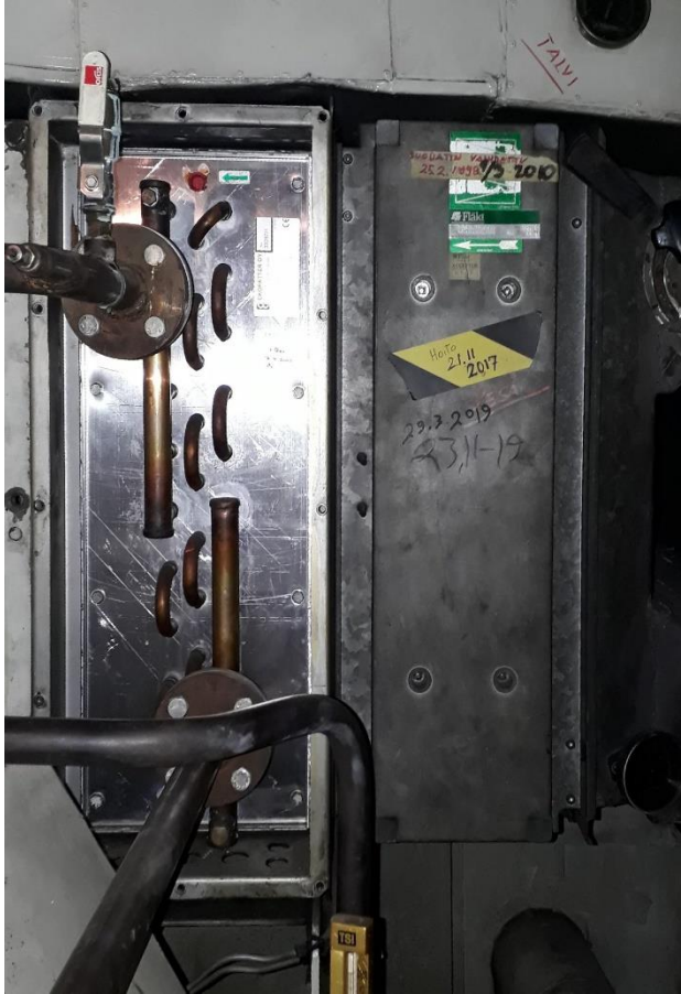
Kuva 9. Vasemmalla sähkövastusten paikalle asennettu lämmönvaihdin.
