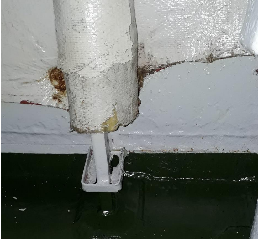
Kuva 11. Kondenssiveden aiheuttamia vaurioita syvyyspommivarastossa.
