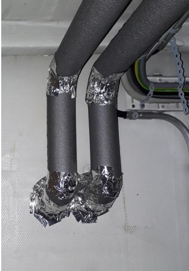
Kuva 8. Kaukolämpöputkien läpivienti panssaroidusta seinästä.
