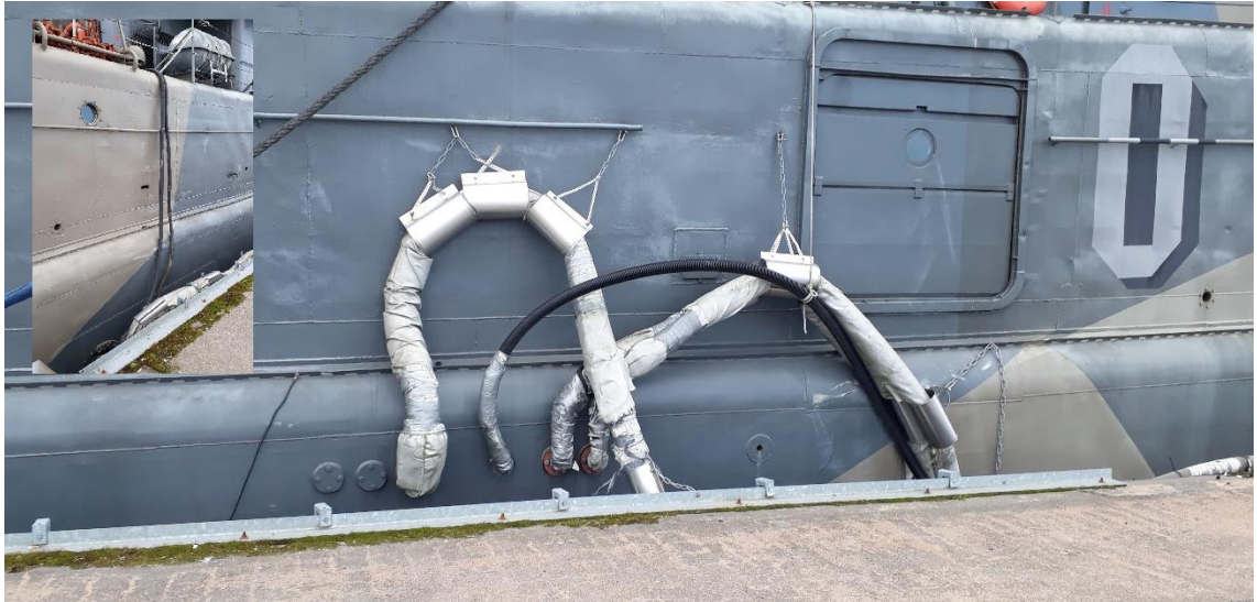
Kuva 5. Jätevesi, käyttövesi ja kaukolämmön tulo- ja poistoputket, sekä sähkön maistaottokaapeli pienessä kuvassa.
