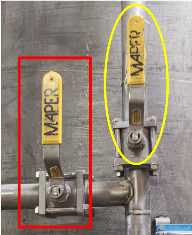
KUVA 1. Venttiilit V-102 ja V-103
