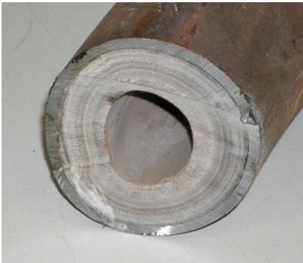
KUVA 7. Putken sisäpintaan ajan myötä muodostunutta kalkkiliusketta (Usgs 2020)
