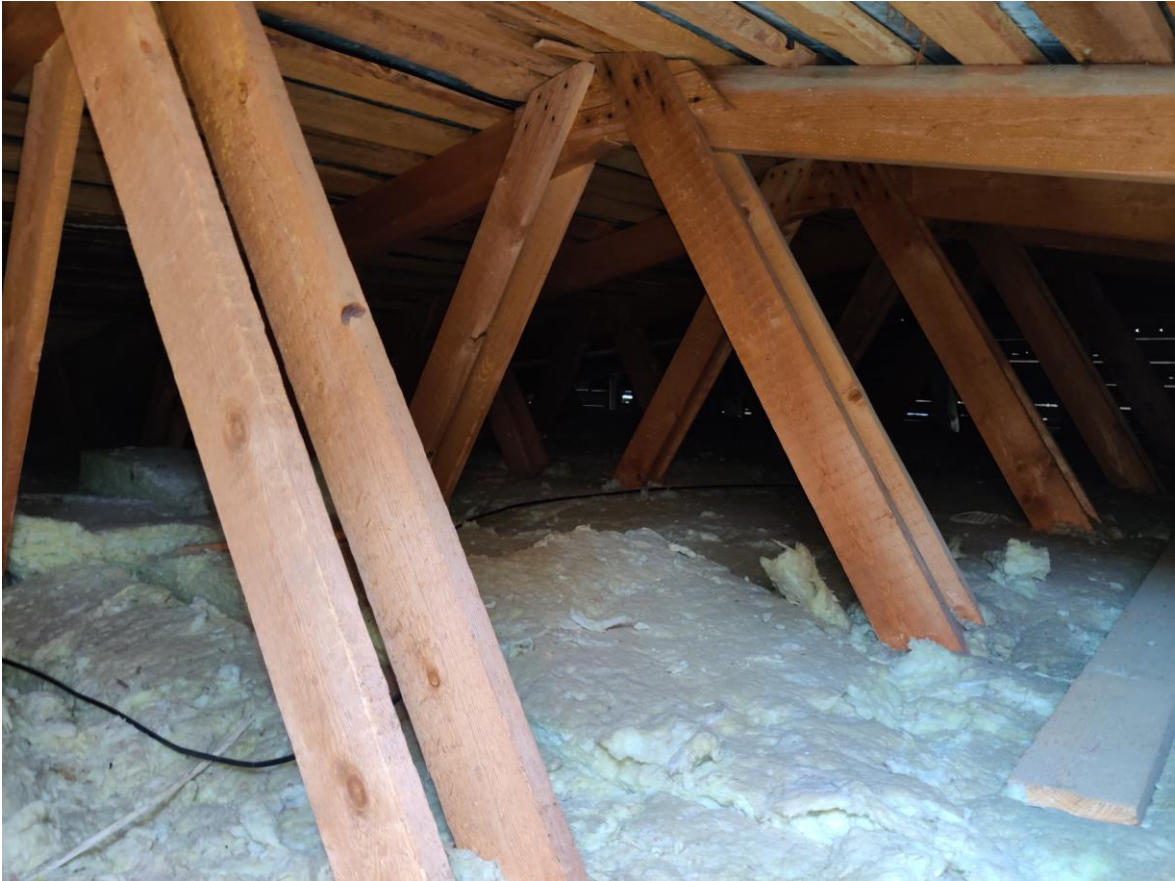
Bild 11. Mellantaket, ett vitt/grått damm som har lagt sig på isoleringen. (Eget foto)
