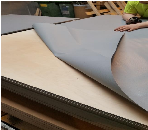
Liite 22 Epäonnistunut liiman levitys
