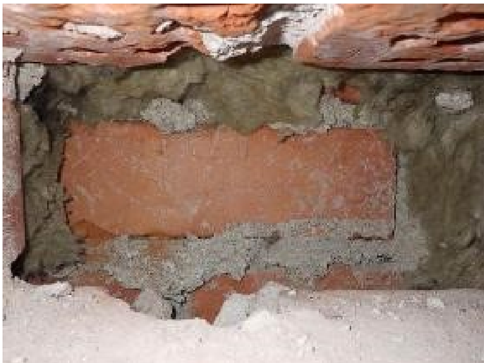
Kuva 9. Rakenneavaus ulkoseinään, rakenteessa ei ole tuuletusväliä.
