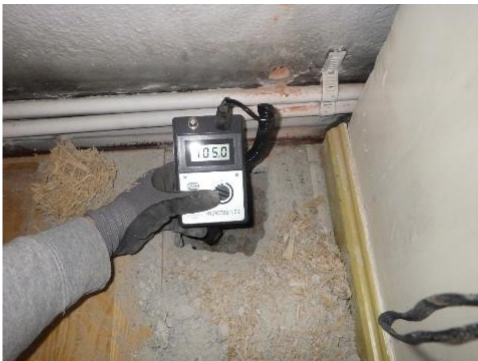
Kuva 13. Rakenneavaus ensimmäisen kerroksen alapohjaan, alalaatassa on pintakosteusilmaisimen perusteella havaittavissa kohonnutta kosteutta.
