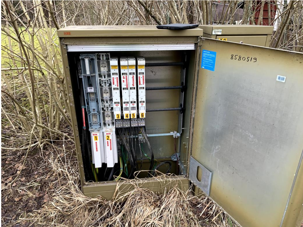
Kuva 2. Kuva 2. Kaapelijakokaappi, ABB MJS-K1.
