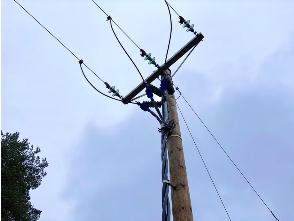
Kuva 3. Kuva 3. KJ-pylväs nousu ja pääteharukset.
