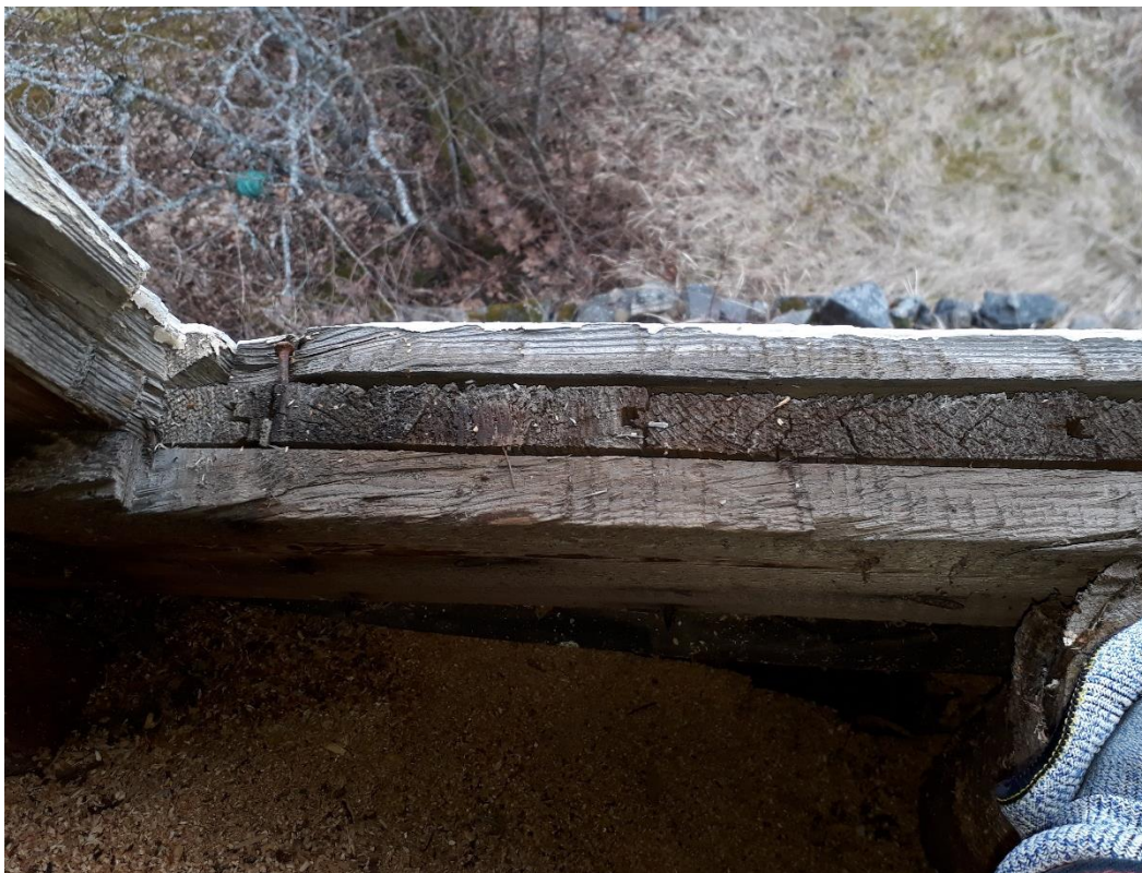
Kuva 20. Vuotokohta vintin ikkunan kohdalla. Vesi pääsee tunkeutumaan seinärakenteeseen.
