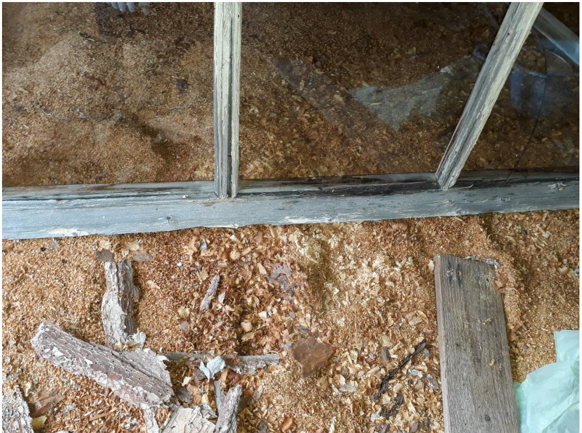
KUVA 21. Vintin huonokuntoisen ikkunan alapuite.
