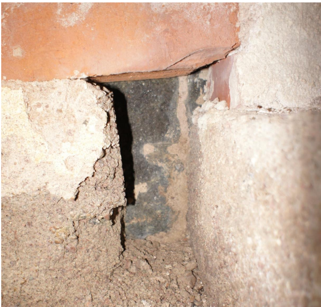
KUVA 09. Rapautunutta betonia kellarissa, raosta näkyvissä luonnonkivimuuraus tiiliverhouksen takana.
