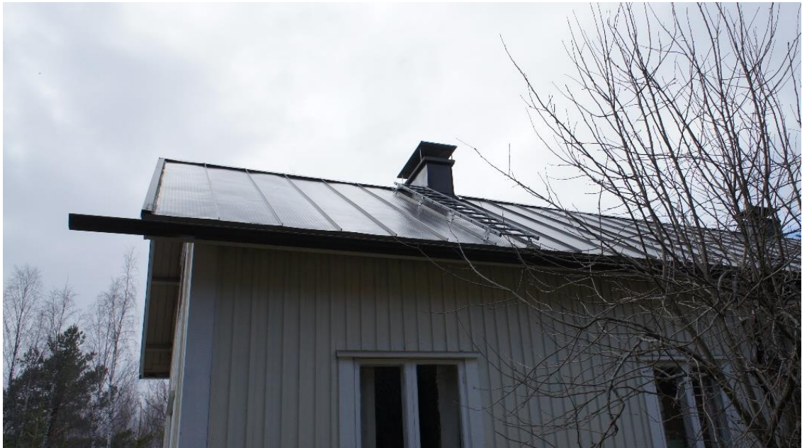
KUVA 23. Sadevesikouru on johdettu etäälle talon nurkalta, vedet johdetaan suoraan maaperään.
