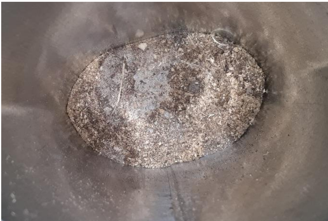
Kuva 14. RA.05.AP Alimmissa, betonia vasten olevissa puruissa havaittavissa lahovaurioita. Kuvassa näkyvää iv-putkea käytettiin apuna rakenneavauksen teossa.
