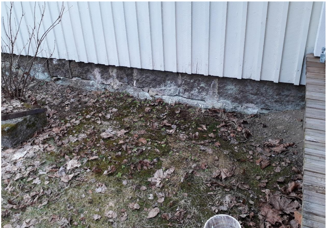
KUVA 08. Kellarin märkä alue ulkoapäin, perusmuurissa jälkiä kosteudesta. Viereisen ulkokatoksen vedet johdetaan kuvan alueelle n. 2 metrin päähän seinästä.
