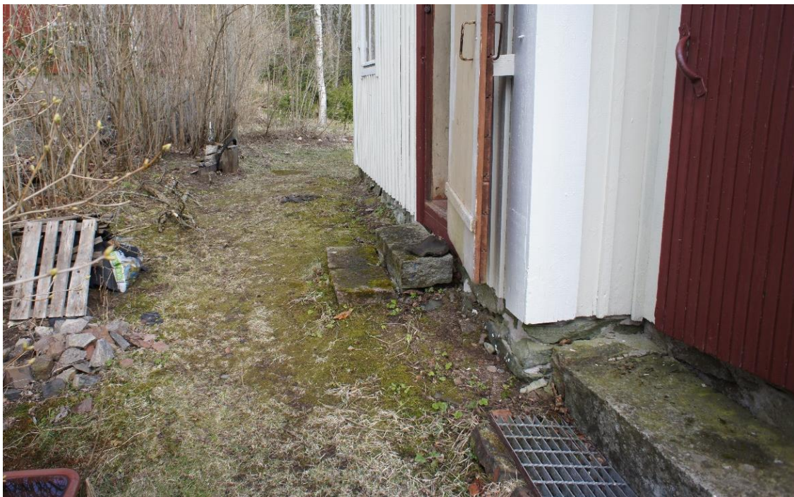
KUVA 28. Pohjoispäädyssä maanpinta on paikoitellen lähellä ulkoseinärakenteen alimpia osia.
