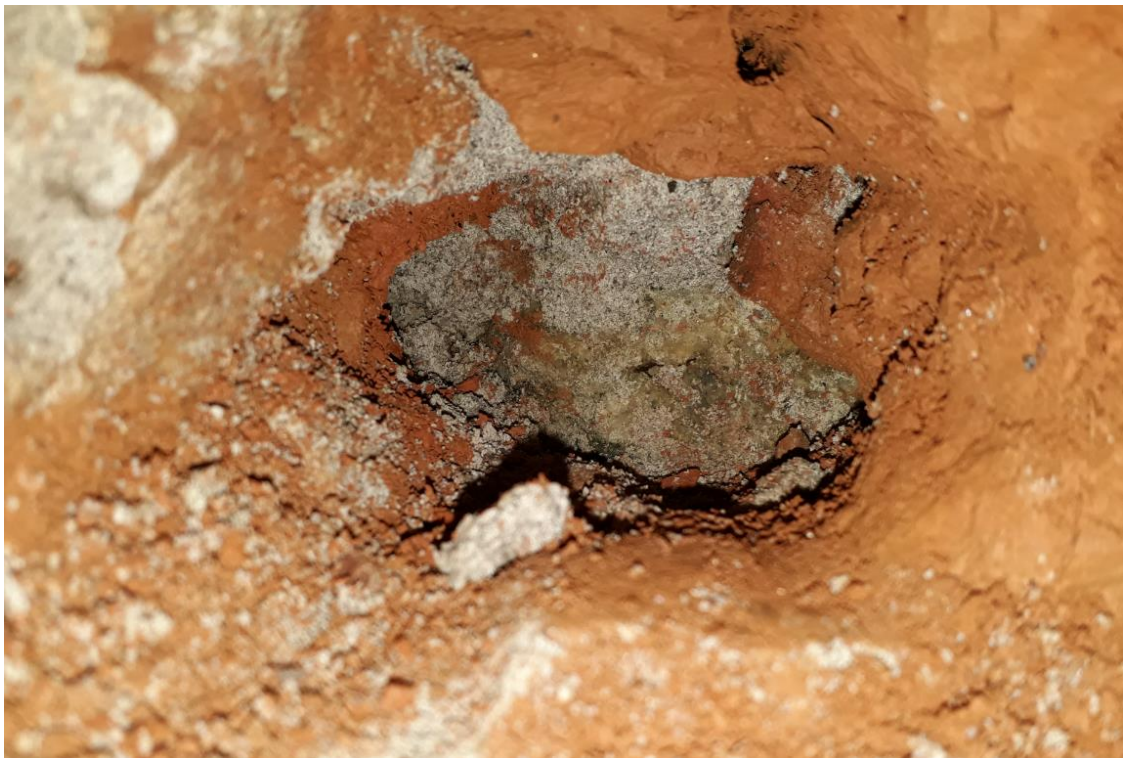
KUVA.06 RA.01.PM. Perusmuurin rakennesavaus kellarin päätyseinässä, tiiliverhouksen takana luonnonkiveä ja muurauslaastia
