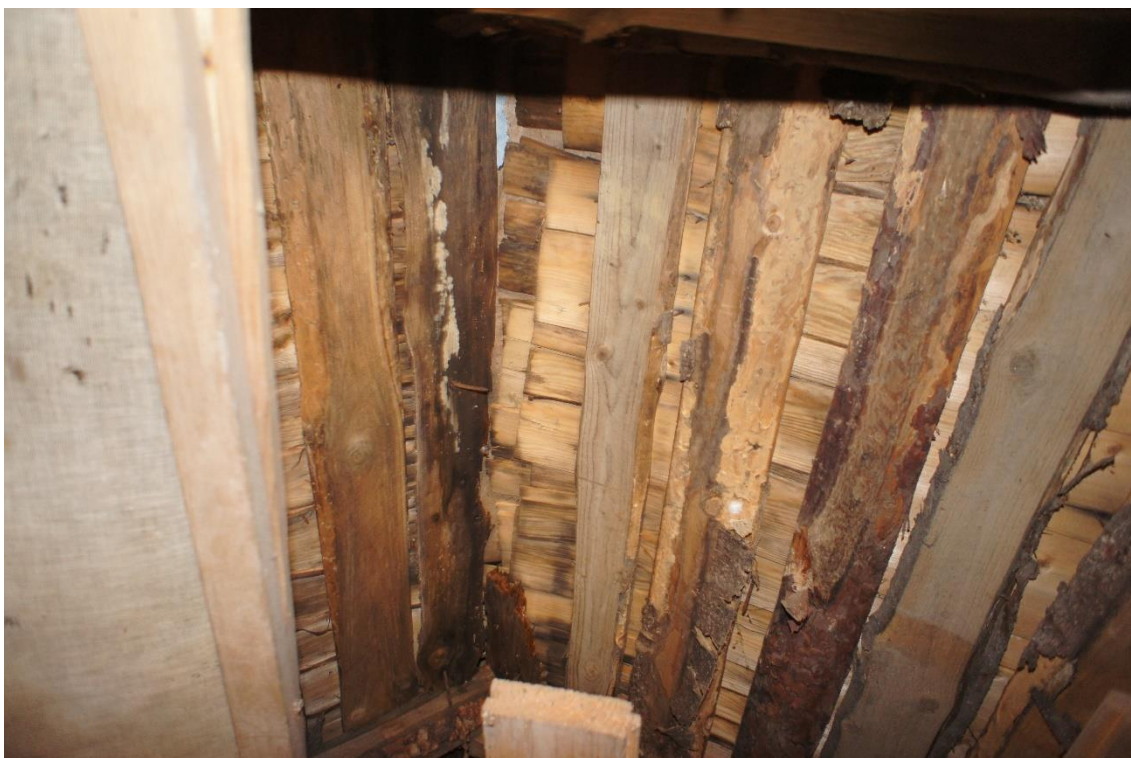
KUVA 24: Vanhojen kattovuotojen aiheuttamia lahovaurioita harjalla.
