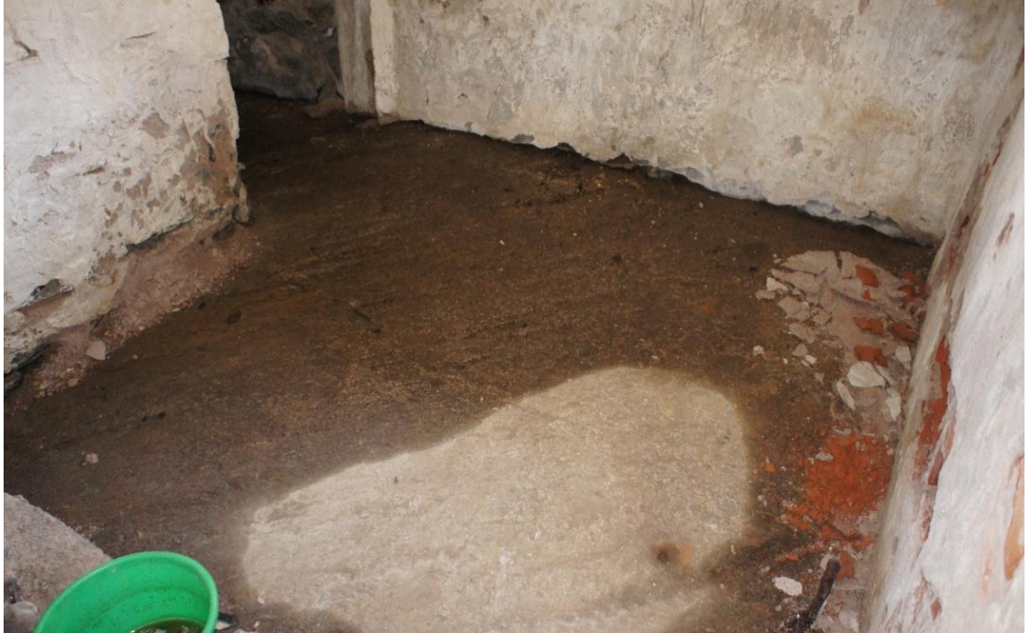
KUVA 07. Kellarin lattia on pääosin kalliopintainen. Kosteutta kulkeutunut kalliota pitkin perusmuurin alta.
