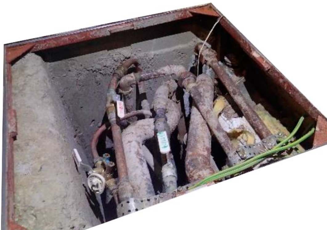
KUVA 1. Rivitalohuoneistojen alla kulkeva tekniikkakanava (Nieminen 2019)
