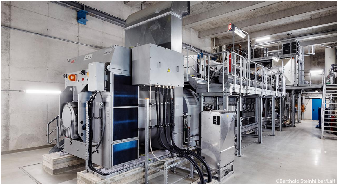
Kuva 3. Stuttgart-Gaisburgin pilottitehtaan generaattori ja maakaasumoottori (8).
