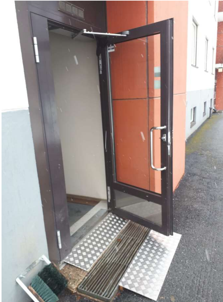
KUVA 15. Ulko-oveen asennettu ovipumppu, jossa mukana liiketutka (Alimaa 2019)
