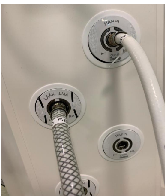
KUVA 2. Kaasunottoventtiilit ja paineletkut
