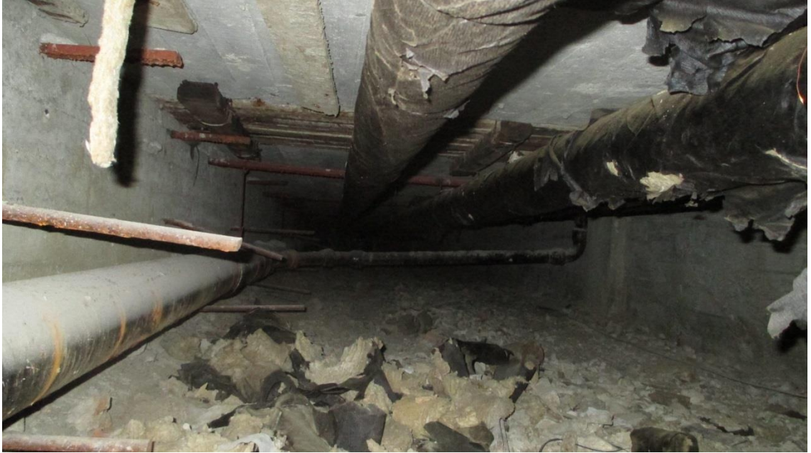
Kuva 8. C-rakennuksen putkitunnelin nykyiset vesijohdot ja viemärit
