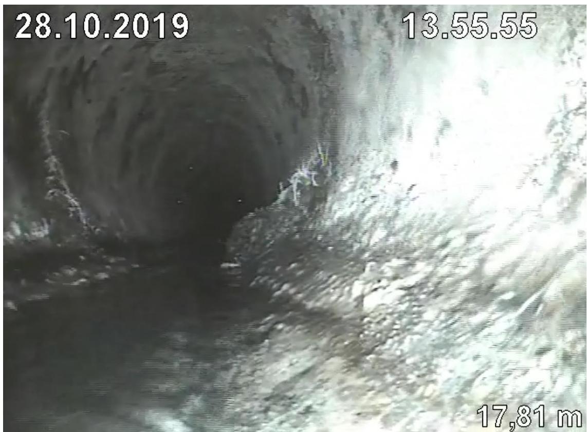
Kuva 5. Alkuperäistä huonokuntoista valurautaviemäriä
