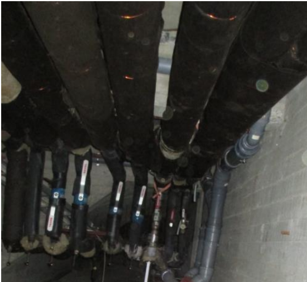
Kuva 19. Lämpöjohtojen urakkaraja tarkentui pystyosalla näkyviin venttiileihin
