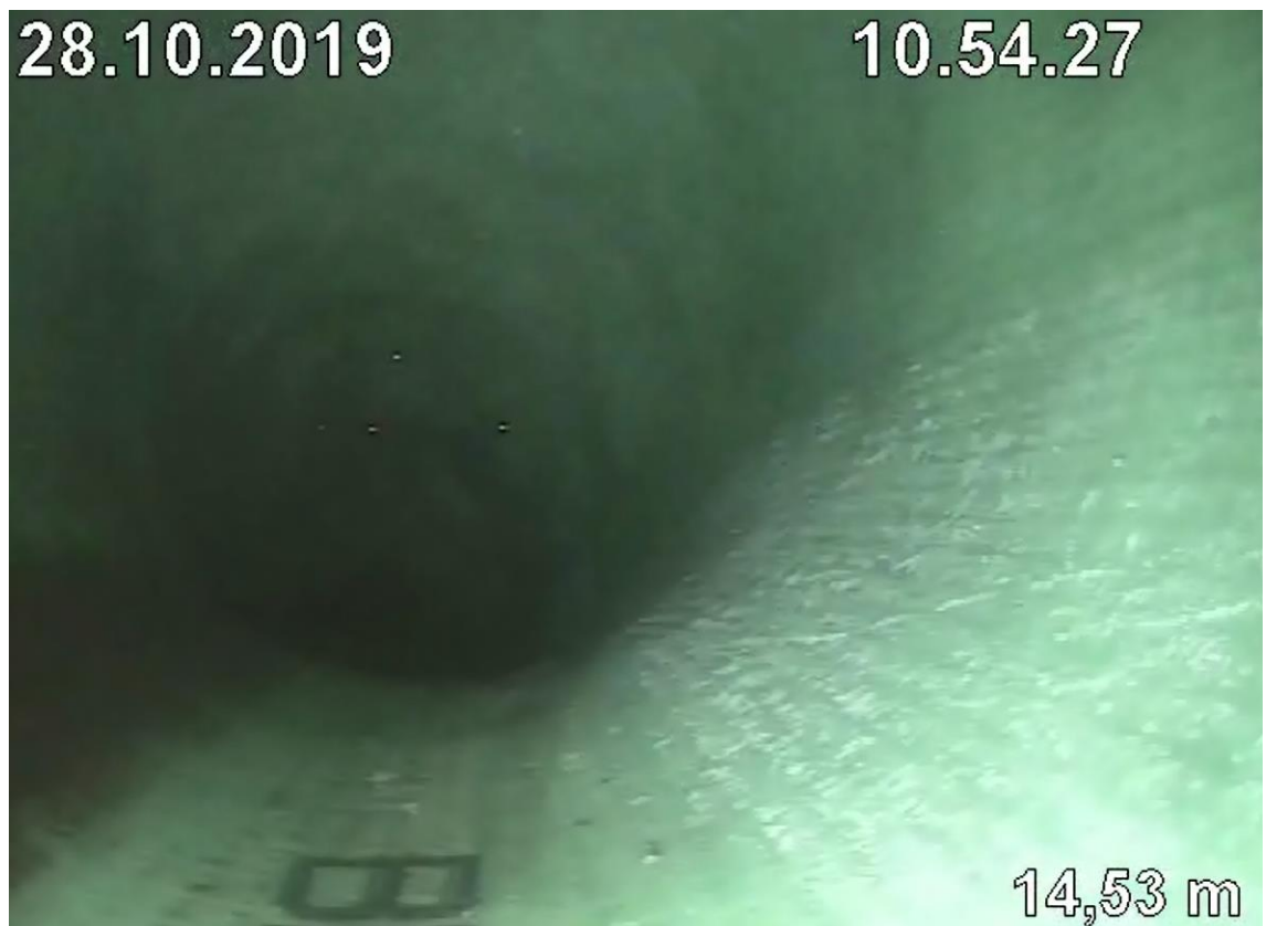
Kuva 7. Sukitettu hyväkuntoinen viemäri
