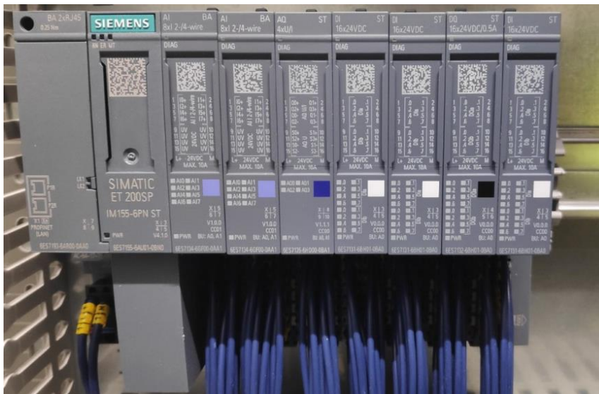
KUVA 2. Siemens ET200SP etä-I/O
