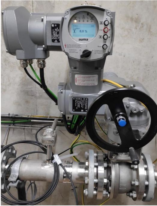
KUVA 4. AUMA AC 01.2 -paineensäätöventtiin XV-016 toimilaite
