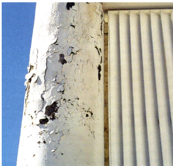
Kuva 2. Pakkasrasituksen aiheuttamaa betonipinnan rapautumista. /9/
