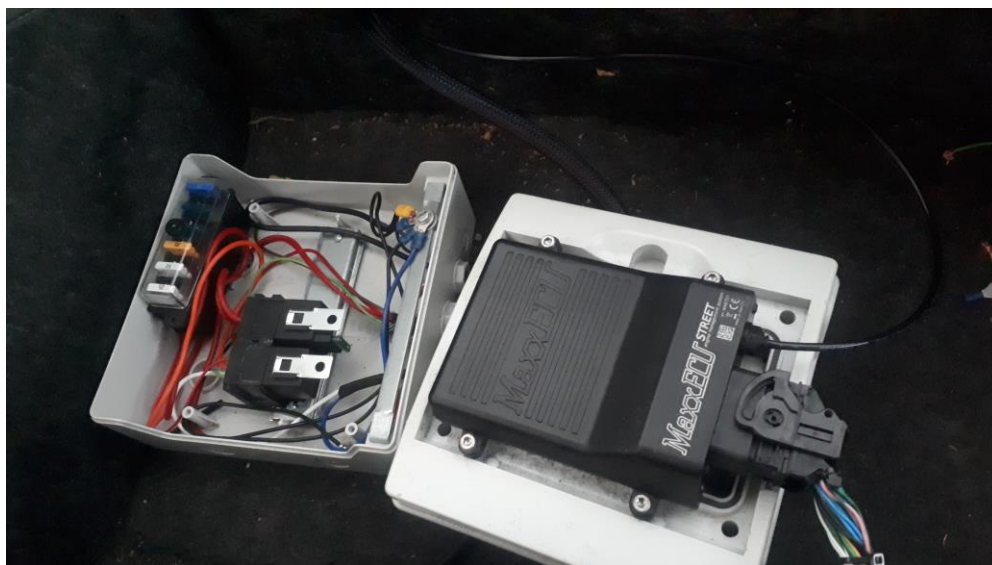
KUVA 35. Moottorin ohjainlaite ja kytkentäkotelo
