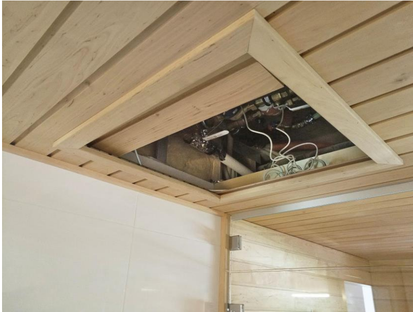
KUVA 14. Veden sulkuventtiilien huoltoluukku (Luttinen, 2020)
