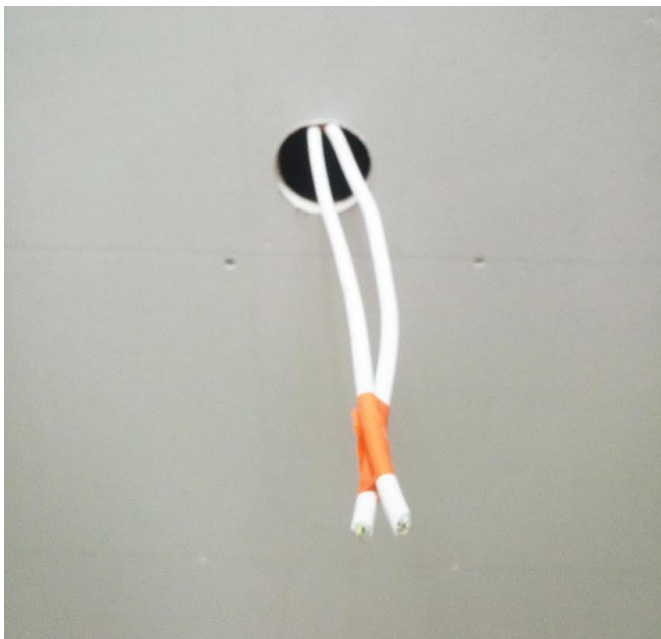
KUVA 18. Valaistuksen johdot on vedetty näkyville läpiviennistä (Luttinen, 2020)
