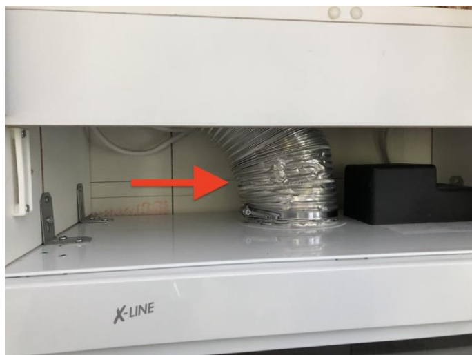
Kuva 8. Ilmanvaihtokanavana käytetty taipuisaa alumiinikanavaa, ns. "kurtutputkea". Juha Heinämäki. 2019. Serviz Oy
