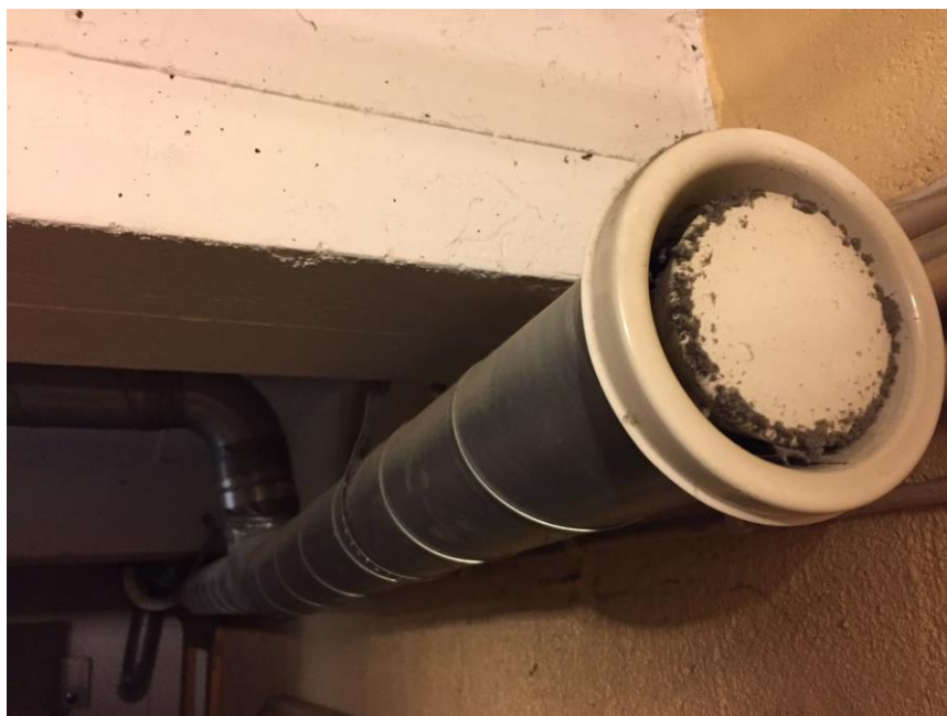
Kuva 7. Selvästi likainen poistoilmaventtiili. Juha Heinämäki. 2020. Serviz Oy
