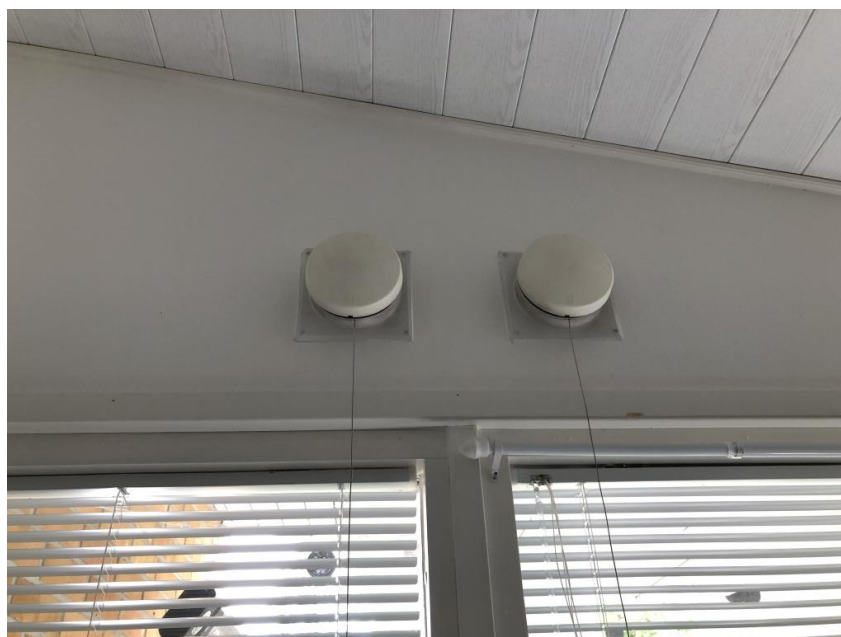
Kuva 4. Korvausilmaventtiilit ikkunan yläpuolella. Juha Heinämäki. 2019. Serviz Oy
