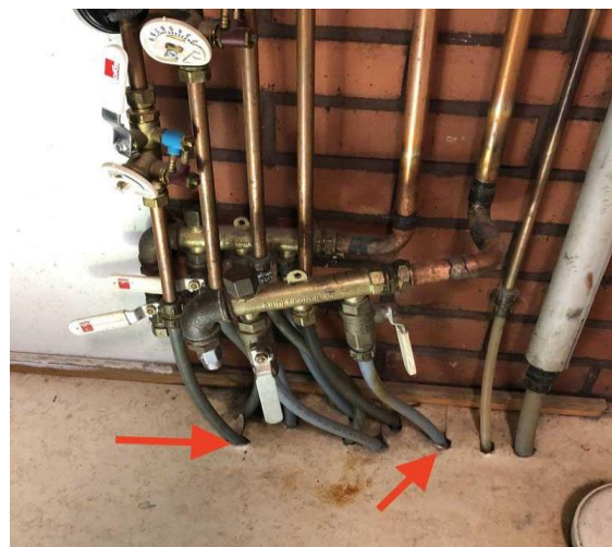
Kuva 23. Vesi valuu suoraan rakenteisiin mahdollisen jakotukkivuodon sattuessa. Juha Heinämäki. 2019. Serviz Oy
