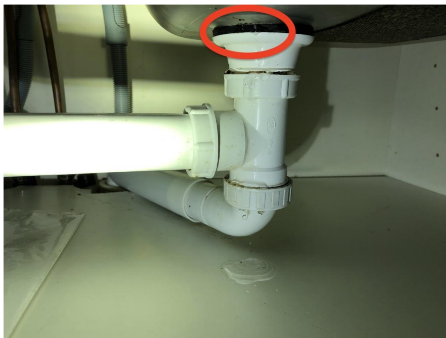
Kuva 16. Viemärin liitos pesualtaaseen vuotaa. Juha Heinämäki 2019. Serviz Oy
