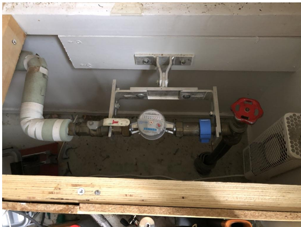
Kuva 28. Vesimittari on hyvin kannakoitu, mutta painemittari puuttuu. Juha Heinämäki. 2019. Serviz Oy
