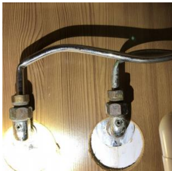
Kuva 20. Väärin tehty mutka ja puutteellinen kannakointi. Juha Heinämäki. 2020. Serviz Oy
