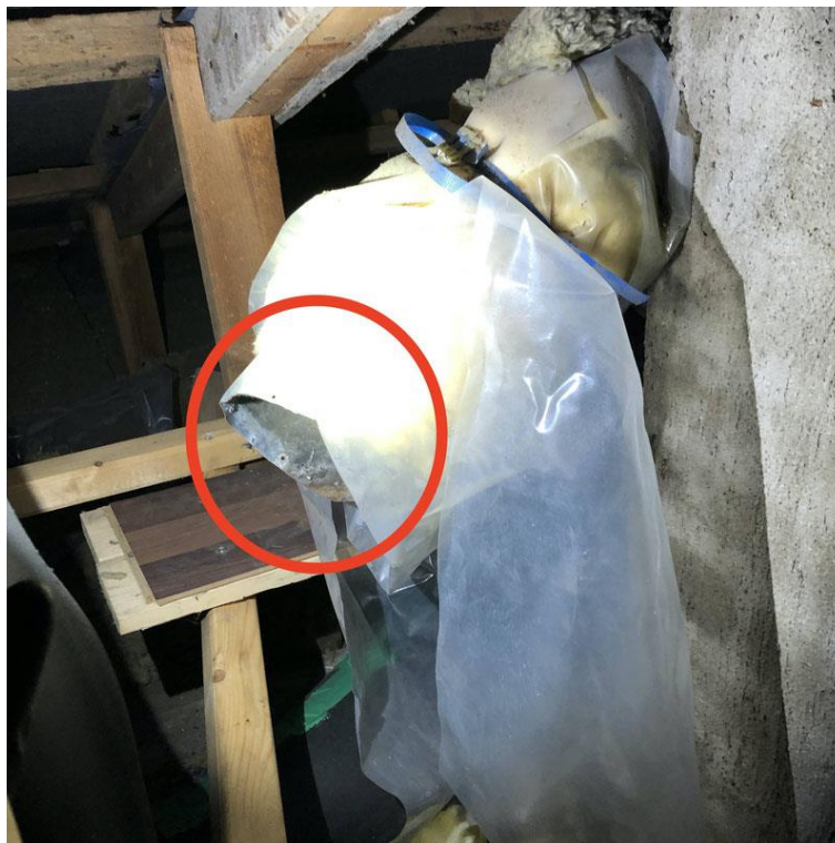
Kuva 3. Ulkoilmakanava alkaa virheellisesti yläpohjatilasta. Juha Heinämäki. 2019. Serviz
