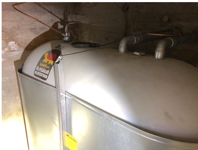
Kuva 31. Öljysäiliö oikeaoppisesti kaukalossa sisätiloissa. Juha Heinämäki. 2019. Serviz Oy
