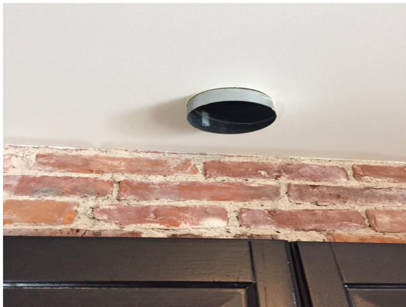
Kuva 2. Keittiön poistoilmakanava, josta puuttuu venttiili. Juha Heinämäki. 2019. Serviz oy
