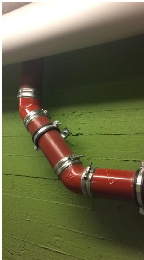
Kuva 10. Valurautaisen pystykokoojaviemärin ja pohjaviemärin mutka toteutettu loivakaarisena ja kannakoitu tukevasti. Perttu Myllymäki 2020
