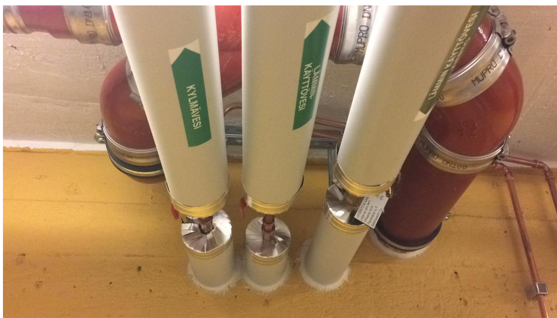
Kuva 24. Höyrytviisti eristettyjä vesijohtoja. Perttu Myllymäki 2020
