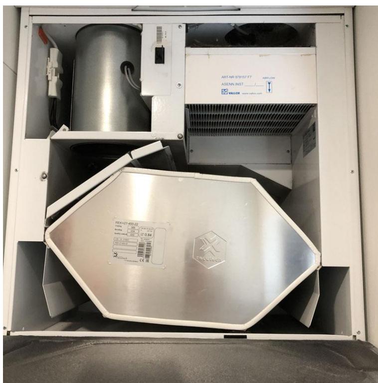
Kuva 6. Ilmanvaihtokone. Juha Heinämäki. 2019. Serviz Oy
