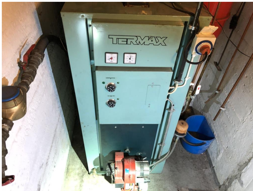
Kuva 33. Öljylämmityksen kattilalaitos. Huoltohistoria saattaa löytyä kattilan kyljestä. Juha Heinämäki. 2019. Serviz Oy
