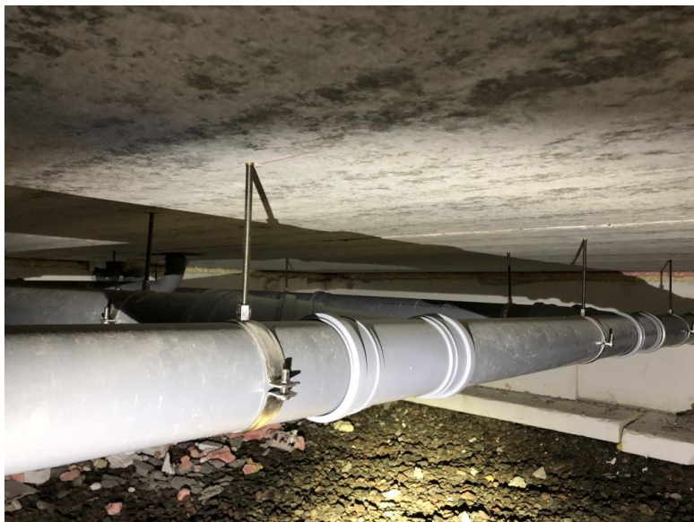
Kuva 15. Muovinen viemäri kannakoitu hyvin alapohjan ryömintätilassa. Juha Heinämäki. 2019. Serviz Oy
