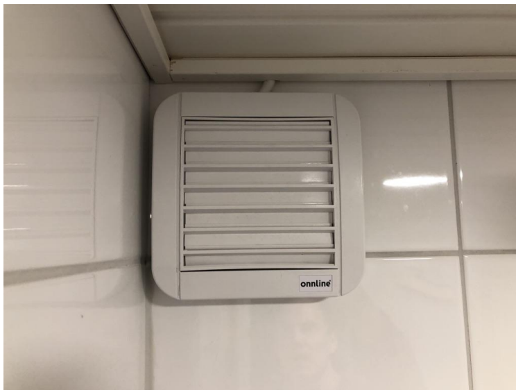
Kuva 1. Hetkellisesti toimiva puhallin tehostaa pesuhuoneen kuivatusta. Juha Heinämäki. 2019. Serviz Oy
