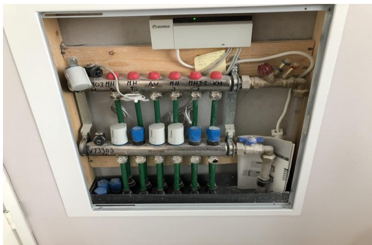
Kuva 22. Jakotukkikaapin pohjalle on asennettu vuotokaukalo mahdollisten vuotojen varalle. Juha Heinämäki. 2019. Serviz Oy
