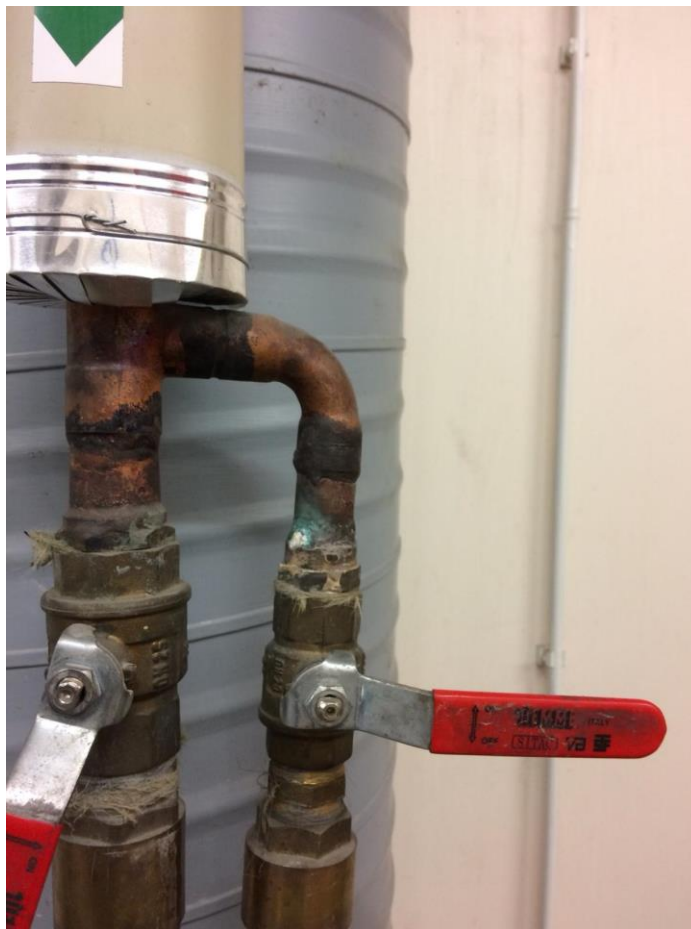
Kuva 18. Pistekorrosiota kupariputken ja venttiin liitoskohdassa. Perttu Myllymäki 2020
