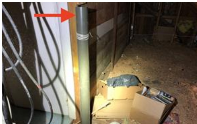
Kuva 11. Eristämätön tuuletusviemäri päättyy yläpohjatilaa. Tuuletusviemäri tulee johtaa vesikatolle eristettynä. Juha Heinämäki. 2019. Serviz oy
