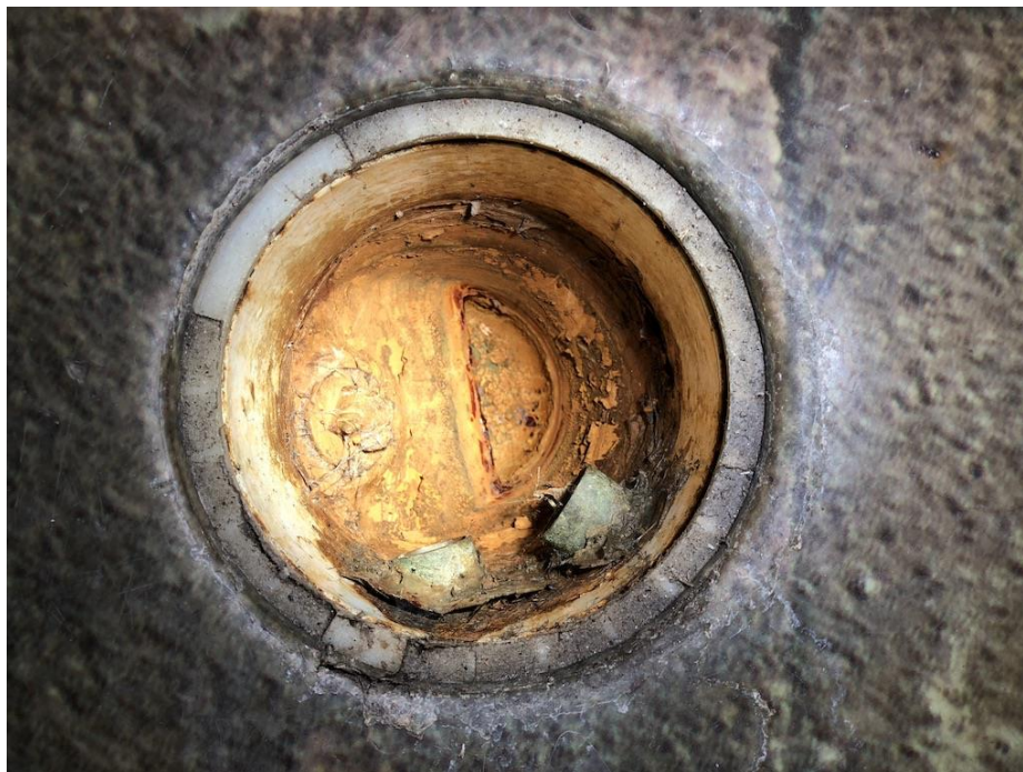
Kuva 12. Ruostunut valurautainen lattiakaivo, jossa on kaksi vesipistettä. Tiiveys on epävarma. Juha Heinimäki. 2019. Serviz Oy
