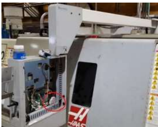
KUVA 16. Ohjaustaulu aukaistuna, releen paikka korostettuna
