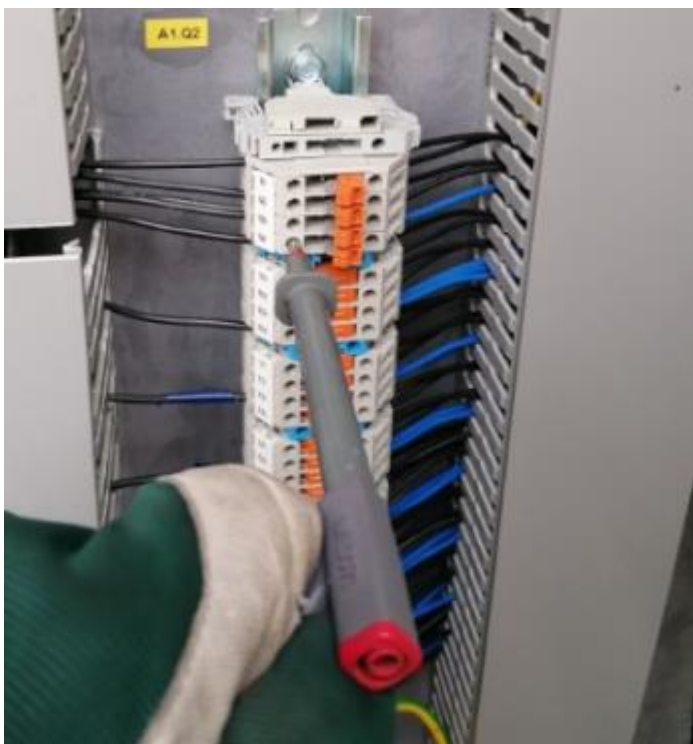
Kuva 9. Kojeella sijaitsevat erotusliittimet
