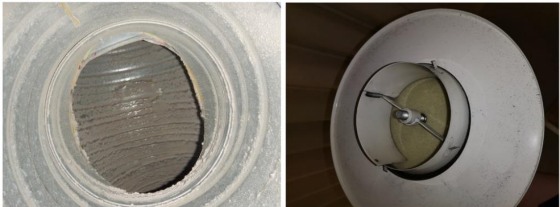
Kuva 21. Likainen poistoilmakanava ja tuloilmapäätelaitteen reunoille kerääntynyttä mustaa pölyä.
