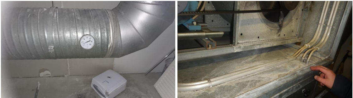
Kuva 20. IV-koneen jäteilmakanavan osat olivat konehuoneessa eristämättä ja tulopuhaltimen luona kuivuneita vesijälkiä.
