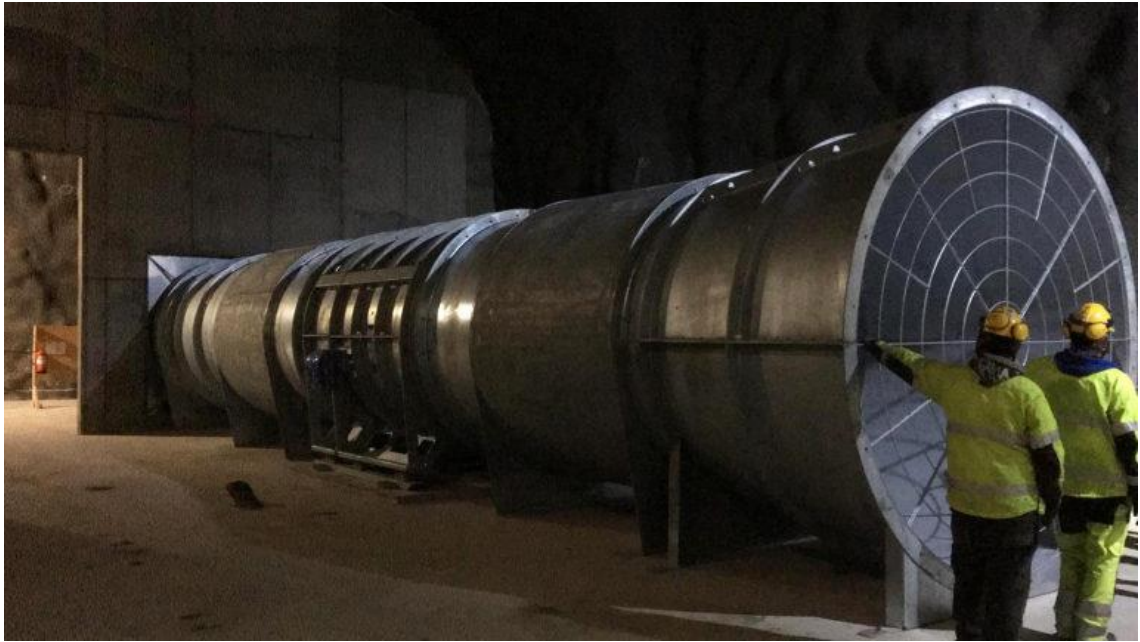
Kuva 2. Kivenlahdessa sijaitsevaan savunpoistokuiluun asennettu savunpoistopuhallin [23].
