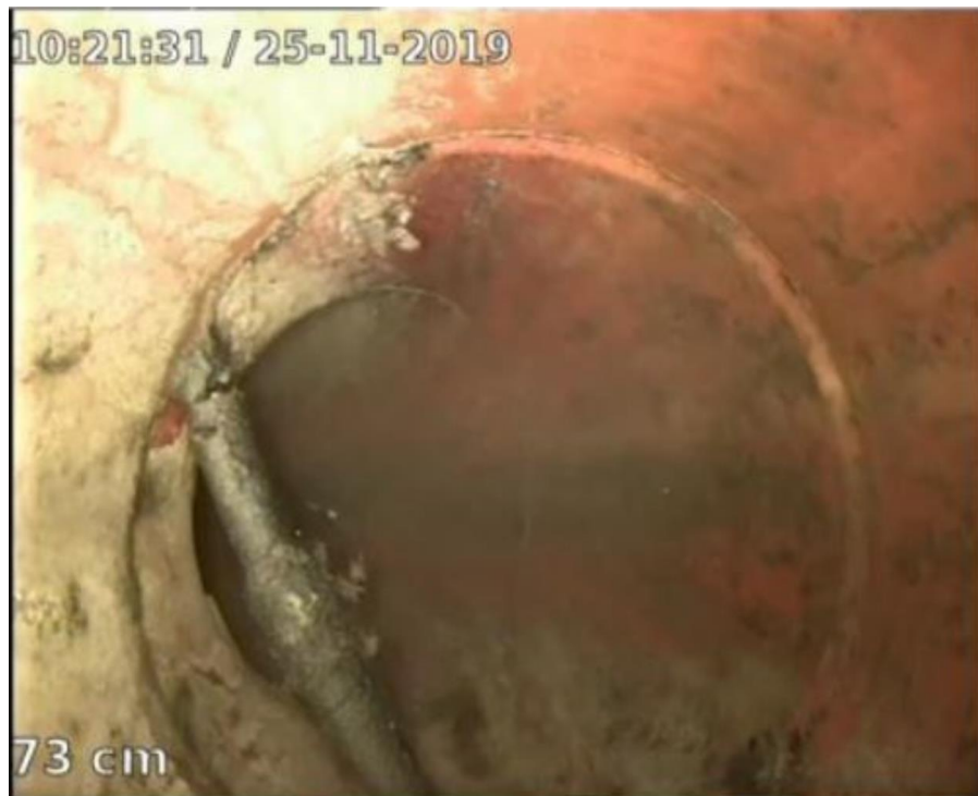
Kuva 12. Tiiviste on linjassa ja lisäksi se on halkeamassa [8]
