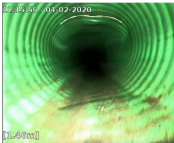
Kuva 10. Kuormituksen seurauksena putki on menettänyt muotoaan ja on muuttunut pyöreästä soikeammaksi ja yläreunassa lisäksi halkeama [8]
