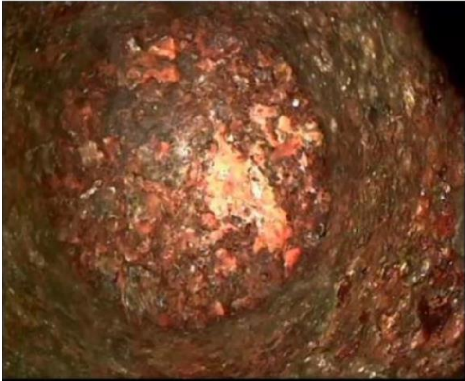
Kuva 14. Ensimmäisessä kulmassa tuuletuksen jälkeen näkyy korroosion aiheuttama irtokeräytymä, joka on tukkinut putken kokonaan eikä kuvassa edes erotu kulmaosuutta. [8]
