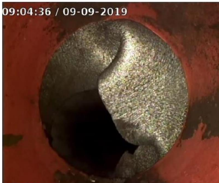
Kuva 9. Putken halkaisijan kutistuminen on ilmeistä, johtuen saumassa olevasta eristematosta [8]
