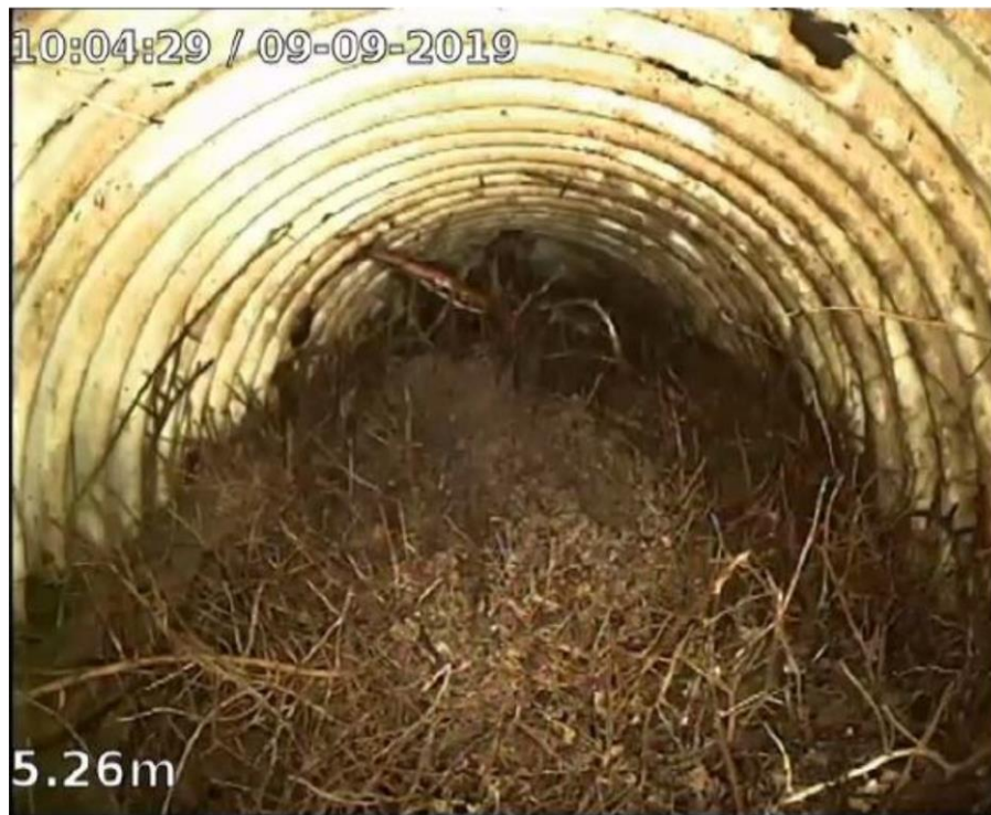
Kuva 8. Salaojaputkessa olevaa juurimattoa [8]
