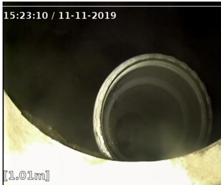
Kuva 6. Viemärijärjestelmässä olevien puutteiden seurauksena siirtymä aiheuttanut putkiliitoksen irtoamisen [8]
