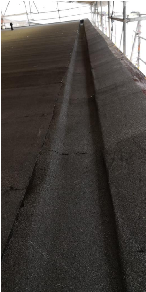
Kuva 1. Vesikouru liikesiiven päällä.
