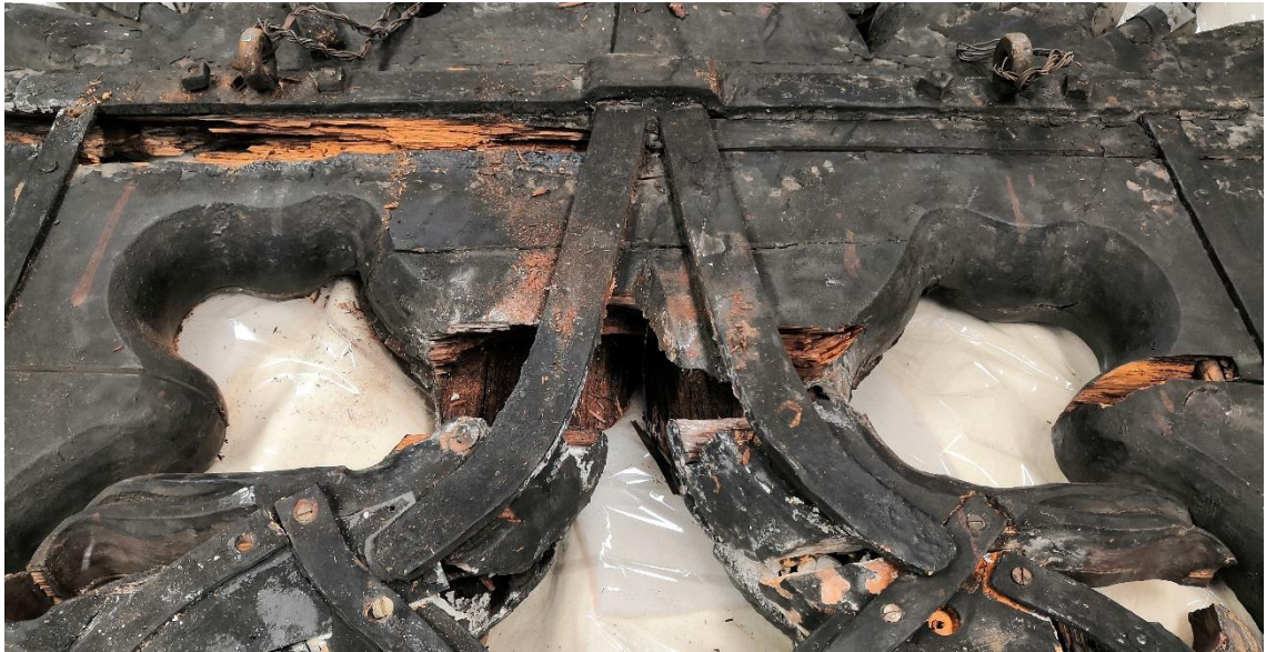
Kuva 10. Lahonnutta puumateriaalia päiden välissä.
