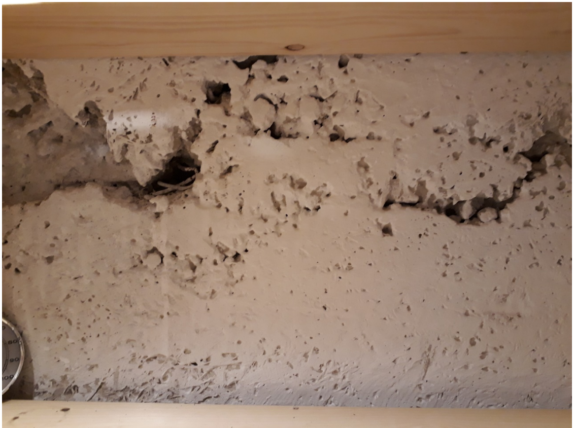
KUVA 18. Kalkittu säästöbetoniseinä juureskellarissa. Kuvaaja: Halla Savisaari
