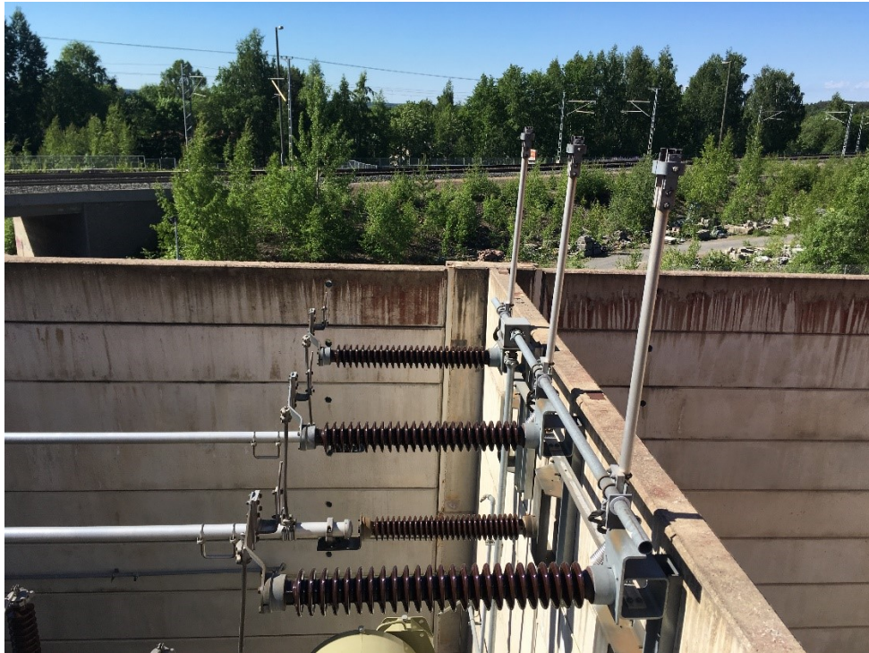
Kuva 15. Työmaadoituslaite Lielahden voimalaitoksella. (Tampereen Sähkölaitos, n.d.)
