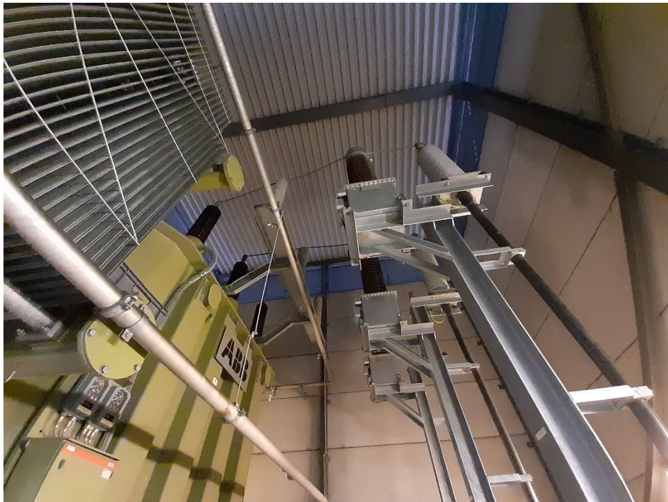
Kuva 18. KTRW 123 X 100- muuntajan yläjännitepuoli.
