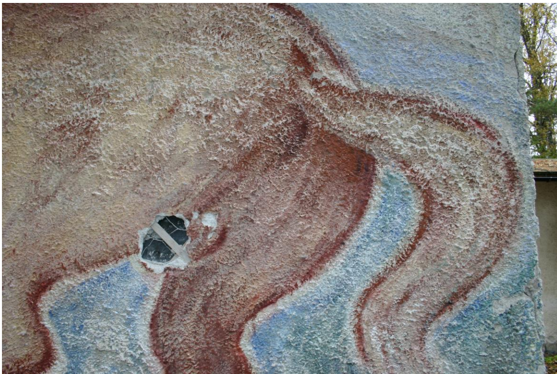
KUVA 9. Vandalismin aiheuttama kolo, josta näkyy seinärakenteen tervapaperi ja metalliverkko.
