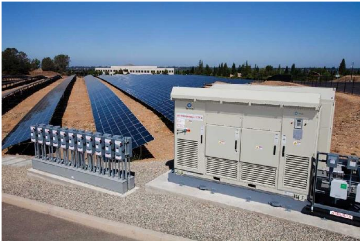
Kuva 15 Keskusinvertterillä varustettu aurinkojärjestelmä. (Rajkumar trading, 2019)
