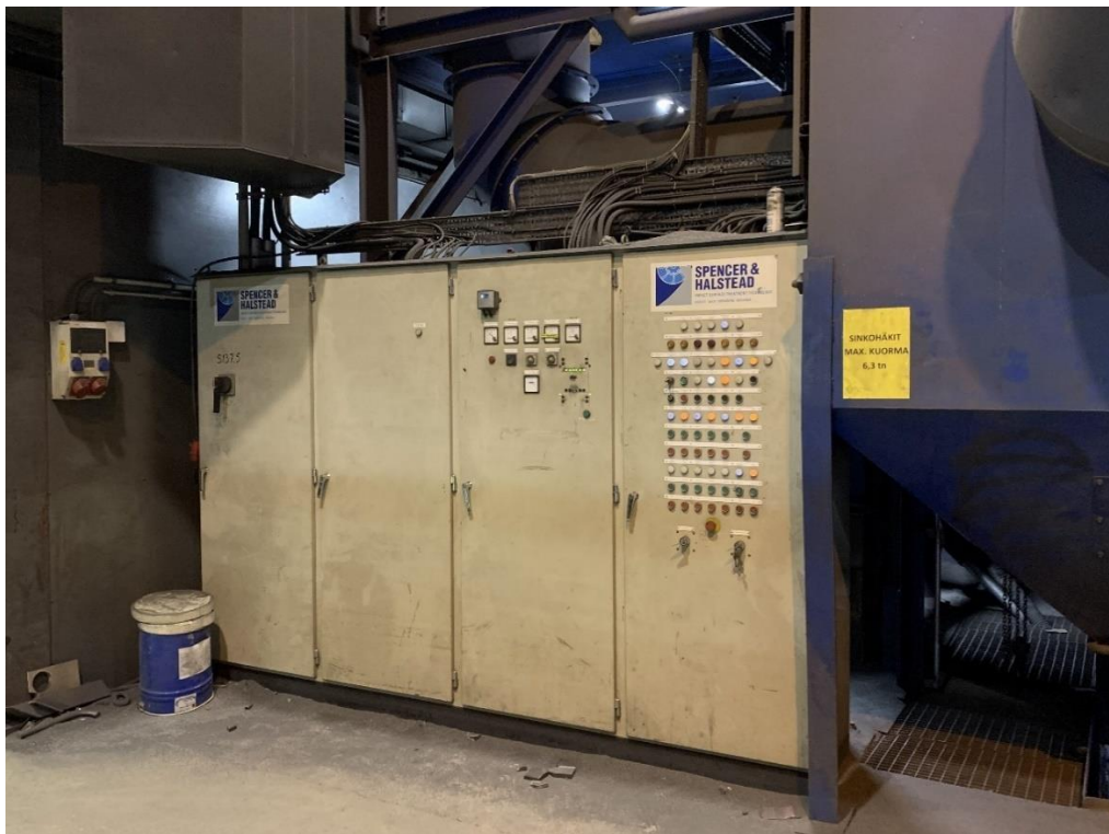
Kuva 20. Sinkopuhalluskoneen nykyinen sähkökeskus.
