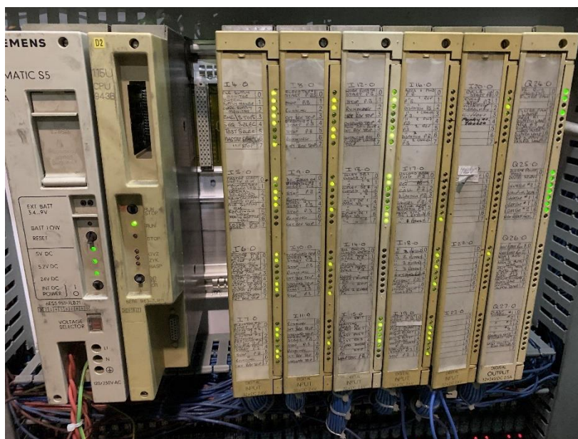
Kuva 19. Sinkopuhalluskoneen nykyinen logiikka S5-115U CPU. (Otra-aho, 2020)
