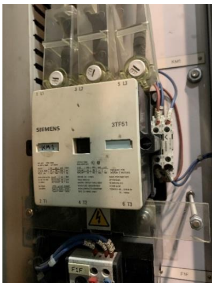
Kuva 28. Siemens 3TF51 kontaktori nykyisessä keskuksessa. (Otra-aho, 2020)
