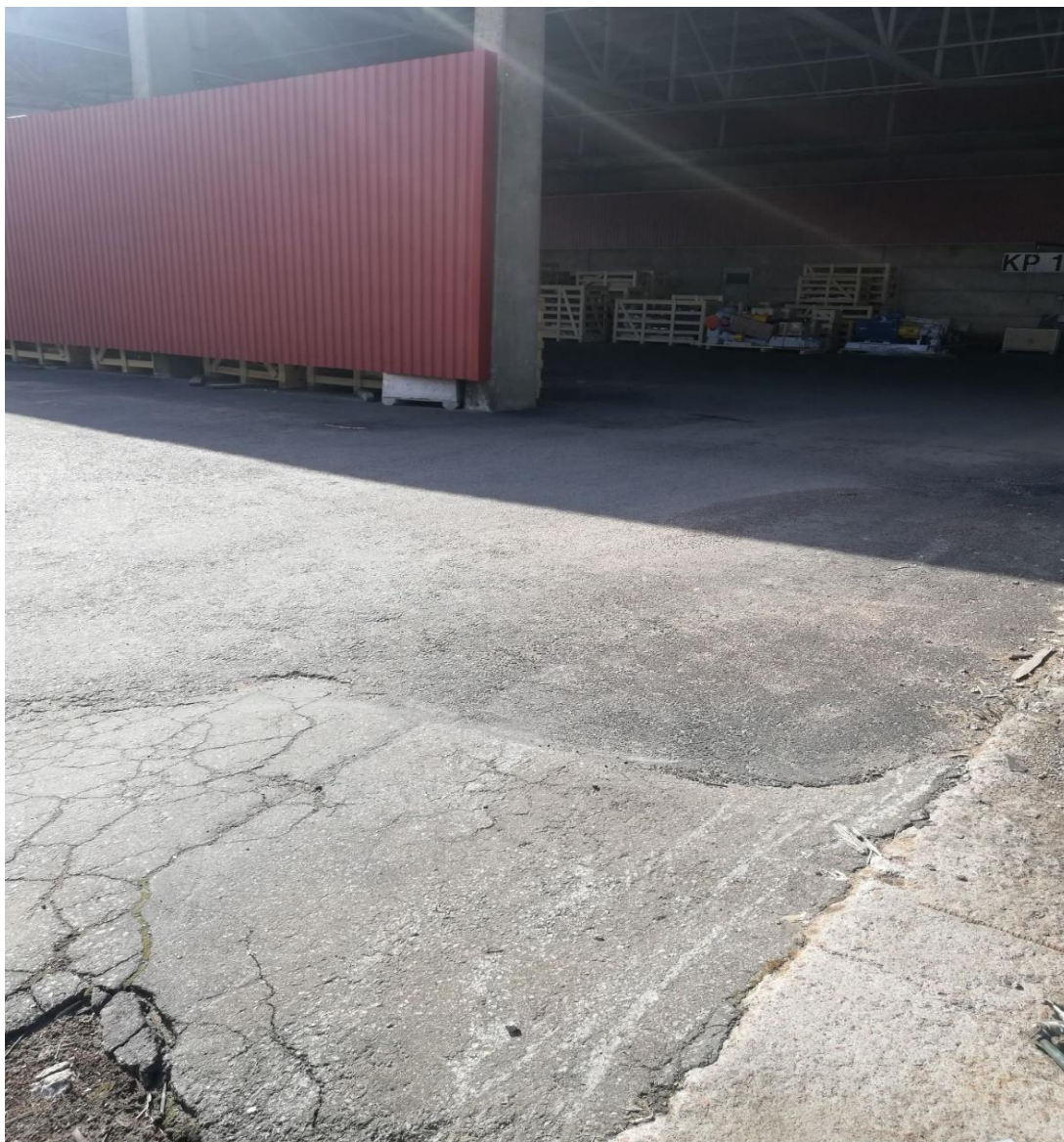
Kuva 3. Lastauspaikalle vievän ajoväylän kaltevuus ja huono kunto aiheuttaa kuorman heilahdusvaaran.
