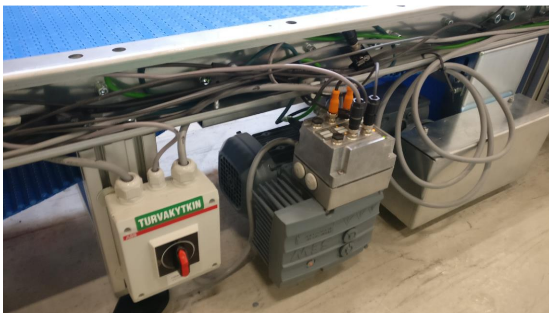
Kuva 6. Taajuusmuuttaja ja moottori kuljettimessa
